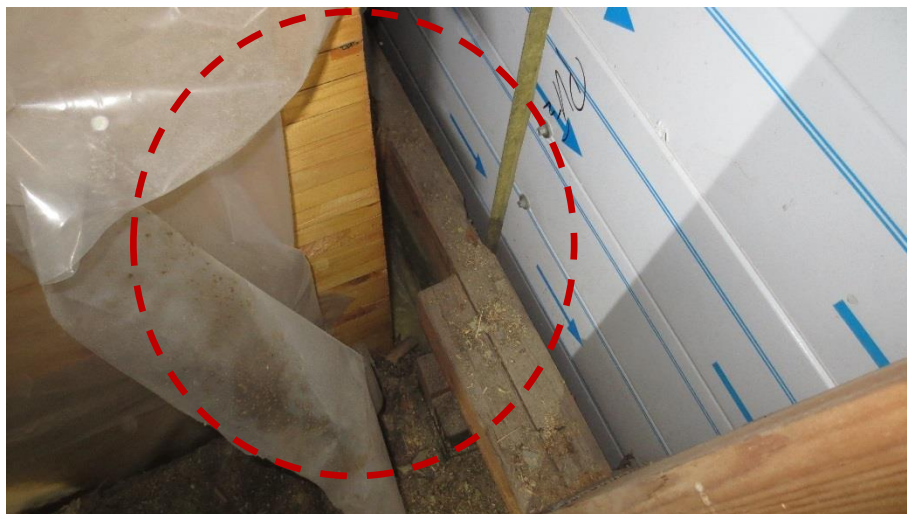
Kuva 10.6. Höyrynsulkumuovi on liimapuukannattajien päissä kokonaan kiinnittämättä ilmanvaihtokonehuoneen seinärakenteeseen.
