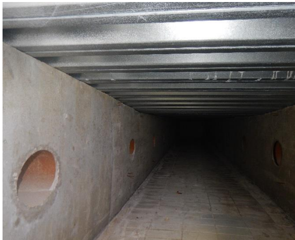
Kuva 5.9 Yleiskuva huoltokäytävästä pohjoispäädyssä ja vaurioita kaivon kohdalla
