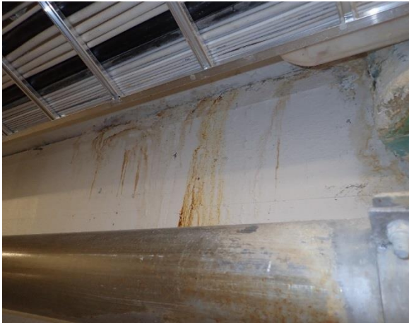
Kuva 5.11 Vuotoa laatan liittokohdassa eteläpuoleiselta huoltokäytävältä kuvattuna
