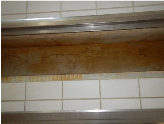
Kuva 3.6 Halkeama loiskekourun pohjassa
