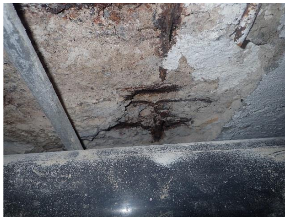
Kuva 5.19 Vaurioitunut raudoite paljastettu vasaroimalla
