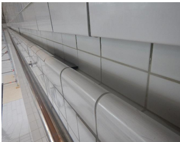
Kuva 4.9 Loiskekouru ja teräslevyllä suojattu vedenpoistoputki (käytössä)
