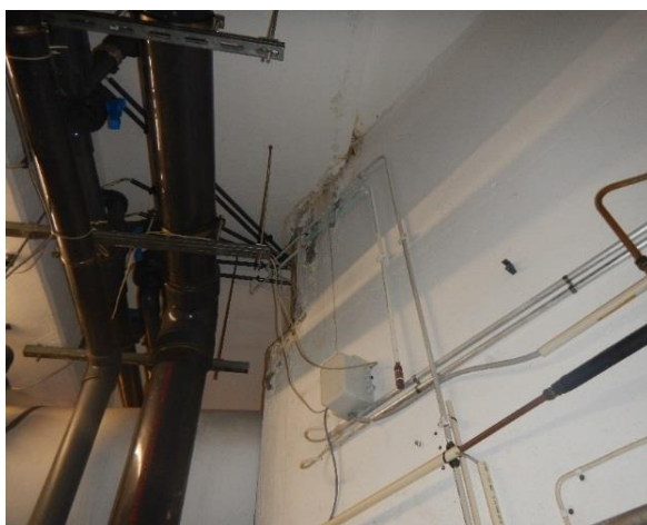
Kuva 6.6 Suuri vuoto altaan vieressä aiheuttanut betonin halkeilua
