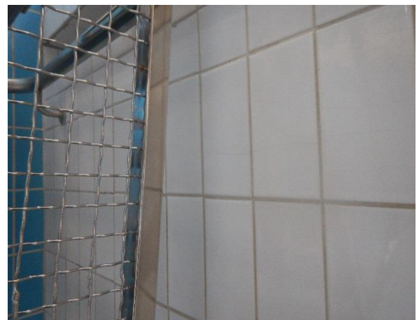
Kuva 4.10 Suojaverkko matalan päädyn tikkaiden kohdalla (kiinnijäämisen mahdollisuus)
