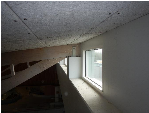
Kuva 11.14. Ristikon yläpään liitos ja vuotojälki ristikossa
