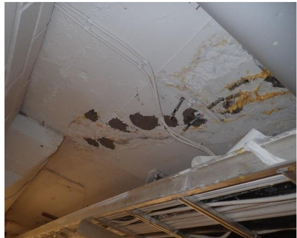
Kuva 5.10 Laatassa vuotoa lokerikkojen läheisyydessä ja injektointeja
