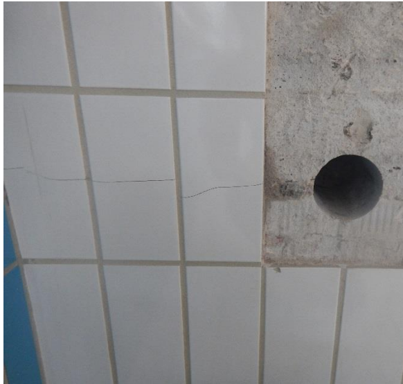
Kuva 5.7 Pukuhuoneiden puolisen laattojen vaakahalkeama
