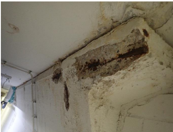
Kuva 4.16 Nurkan vuotokohdasta vasaroimalla paljastettujen teräksien ruostuminen
