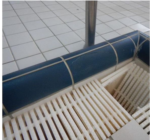
Kuva 5.8 Altaan reunan kaarevissa laatoissa halkeamia
