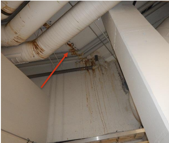
Kuva 3.12 Vuotojälkiä injektoidussa liikunta- saumassa, jonka alla IV-putkia
