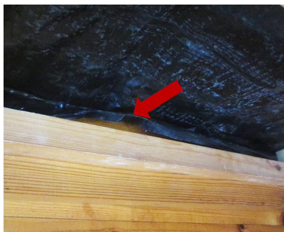
Kuva 10.3. Yläpohjan höyrynsulkumuovi epätiivis liitos allashallin puolelta kuvattuna
