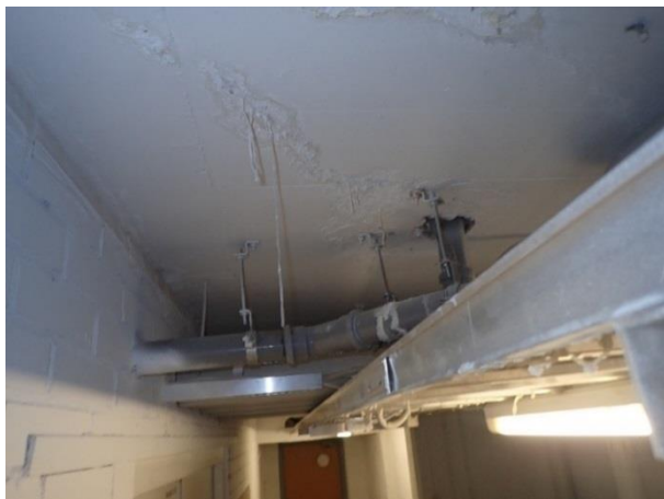
Kuva 4.20 Vuotojälkiä välipohjalaatan halkeamien kohdalla
