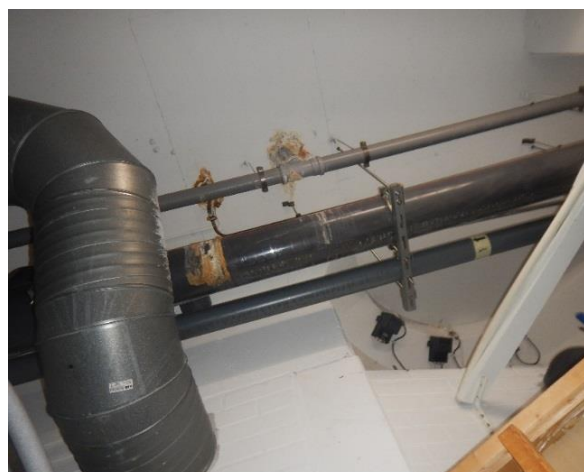
Kuva 6.7 Putken ympärillä vuotoa.
