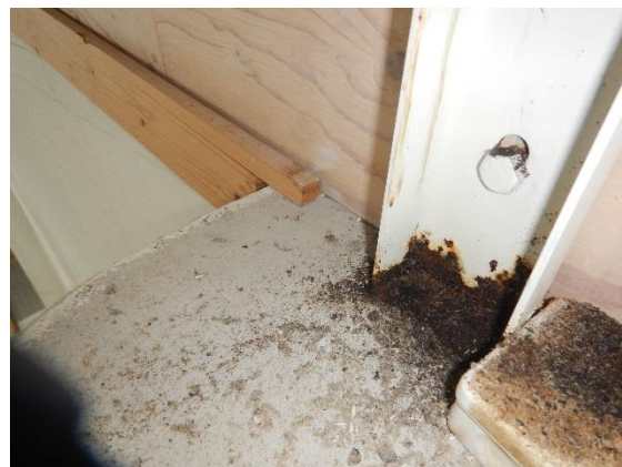
Kuva 11.13. Tuulipilarin ja palkin liitoksessa ruostetta
