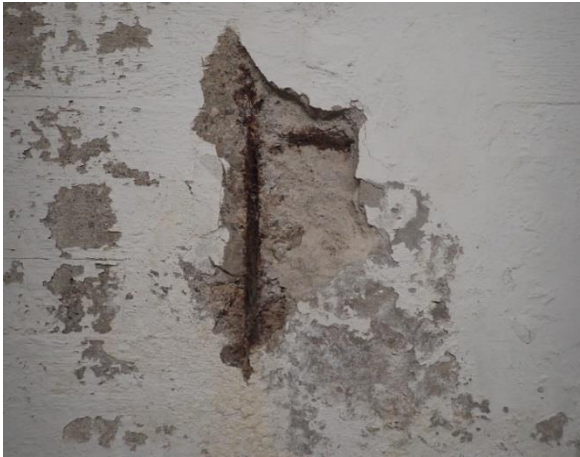
Kuva 4.14 Vuotokohdasta vasaroimalla paljastetut teräkset olivat ruosteessa
