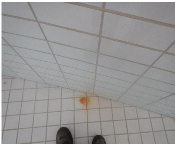
Kuva 6.4 Ruosteen värjäytymää altaan pohjalla
