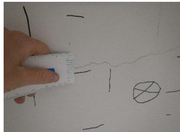
Kuva 3.11 Alapohjan levein halkeama
