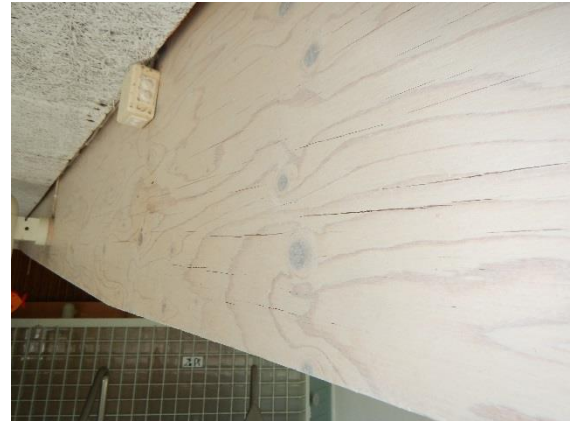
Kuva 11.18. Kapeita ja lyhyitä vaakahalkkeamia palkin kyljessä
