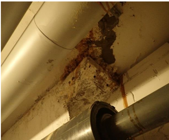
Kuva 5.13 Reunakonsolissa vaurioita ja vuoto-kohta
