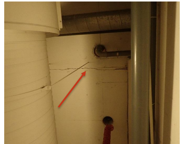
Kuva 3.15 Valuhalkeama kuntoaltaan reunakon- solin vieressä
