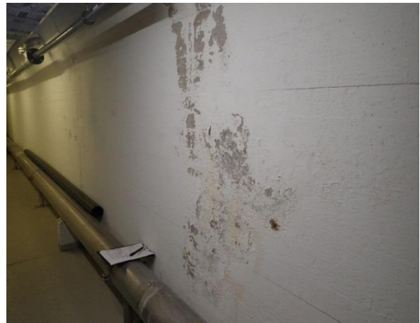
Kuva 4.13 Seinässä havaittavat vuotojäljet ennen vasarointia
