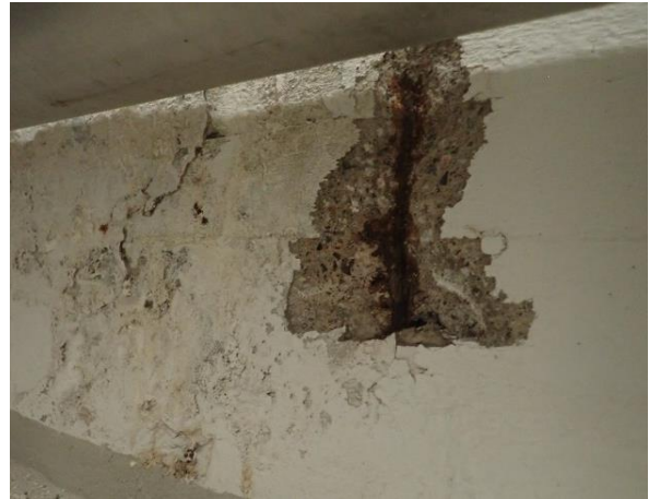
Kuva 4.15 Vuotokohdasta vasaroimalla paljastettujen teräksien ruostuminen
