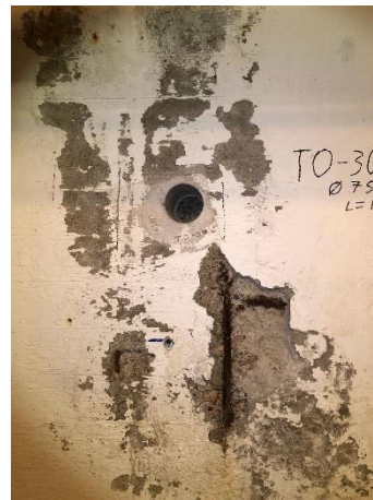
Kuva 4.17 Kaivon vuotokohdasta vasaroimalla paljastettujen teräksien ruostuminen ja näyte TO-3U
