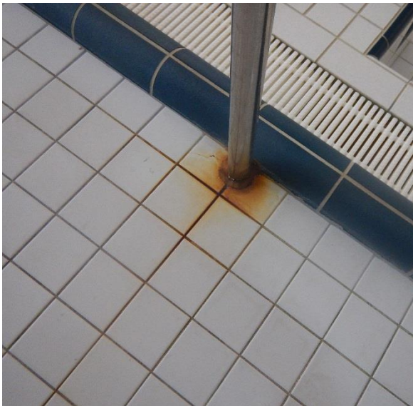
Kuva 5.5 Ruostetta käsijohteen juuressa altaan ulkopuolella
