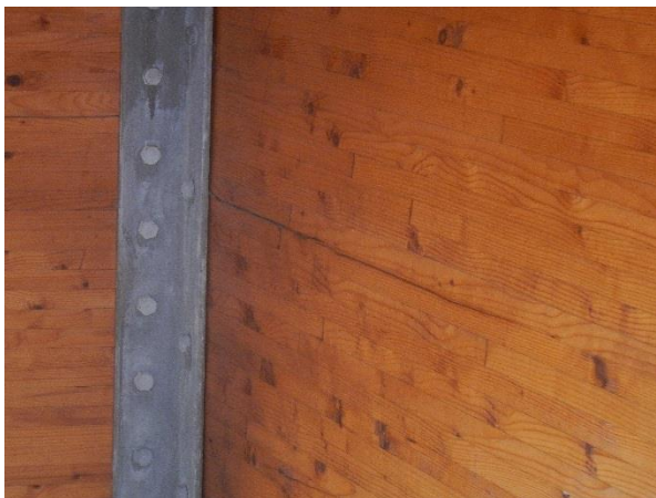
Kuva 11.5. Primääripalkeissa havaittu suurin halkeama
