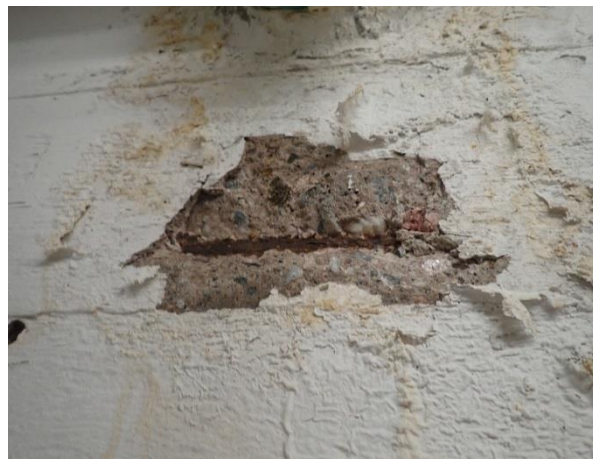
Kuva 5.16 Vaurioitunut raudoite paljastettu vasaroimalla
