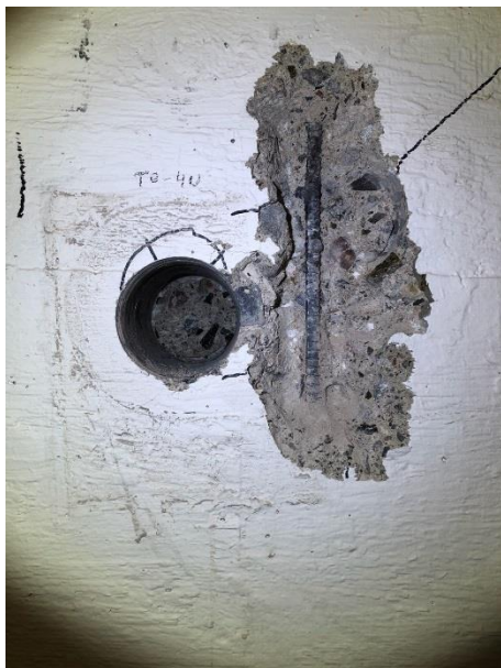
Kuva 4.22 Vuotojälkiä välipohja-laatan halkeamien kohdalla
