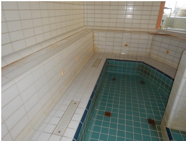
Kuva 9.1 Porealtaassa paljon allastekniikkaa
