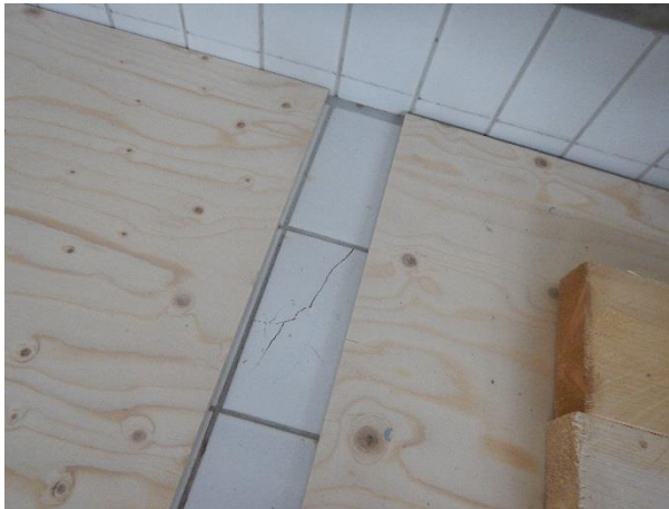
Kuva 4.5 Laatan halkeama syvässä päässä
