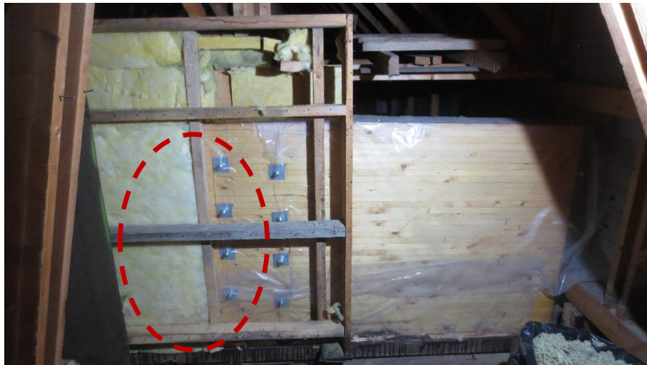
Kuva 10.5. Liimapuupalkin liittimien kohdalla havaittiin reikiä höyrynsulkumuovissa
