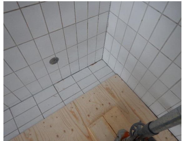
Kuva 4.6 Ruostejälkiä seinän ja alapohjan liitoksessa syvän päädyn nurkassa
