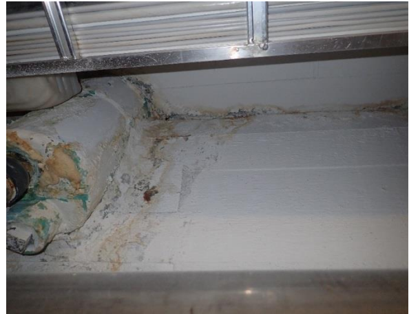
Kuva 5.12 Vuotoa kaivon läpiviennissä eteläpuoleiselta huoltokäytävältä kuvattuna
