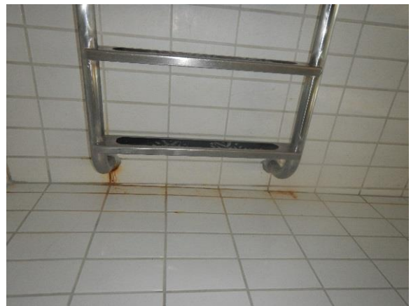
Kuva 3.5 Ruostevärjäytymiä tikkaiden kiinnityskohdassa
