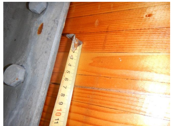
Kuva 11.6. Sekundääripalkissa havaittu halkeama
