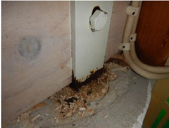
Kuva 11.17. Ruostetta palkin liitoksessa (lastut yläpohjan rakenneavauksesta tippuneita)
