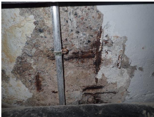
Kuva 5.18 Vaurioitunut raudoite paljastettu vasaroimalla
