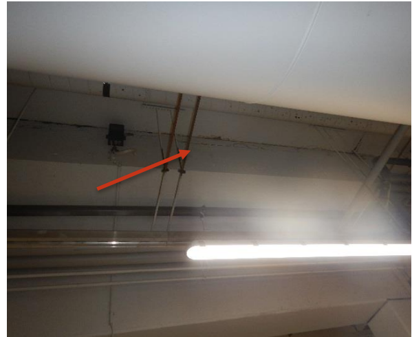
Kuva 3.13 Lohkeama reunakonsolin yläosassa
