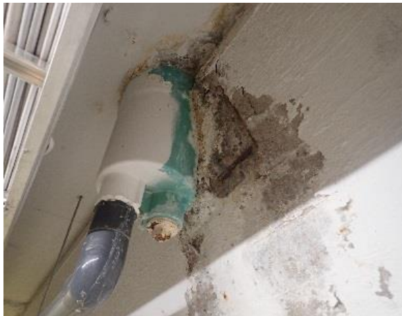
Kuva 4.12 Vuotoa kaivon läpiviennissä
