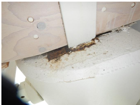
Kuva 11.12. Ristikoiden matalan pään liitoksessa ruostetta
