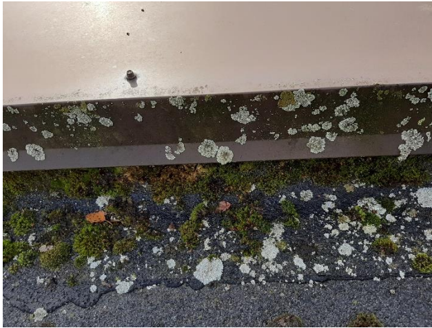
Kuva 14. Sammalta vesikatteen ja räystäspellin pinnassa.
