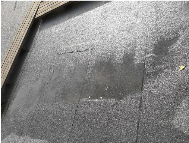
Kuva 12. Kermien saumat on hitsattu vesitiiviiksi. Katon pinnassa on havaittavissa lievää lammikoitumista.
