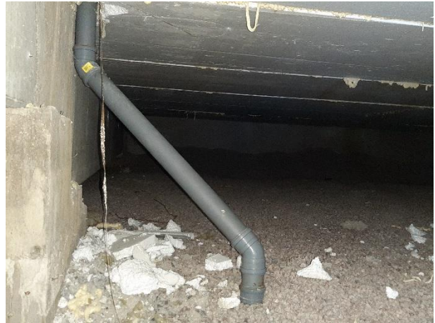
Kuva 6. Ei pystysuorat putket viemäri kannakoida.
