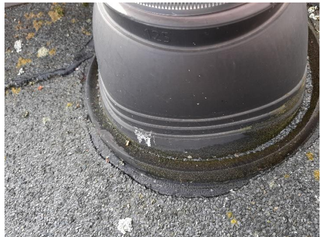
Kuva 17. Toistaiseksi hyväkuntoinen läpivientitiiviste.
