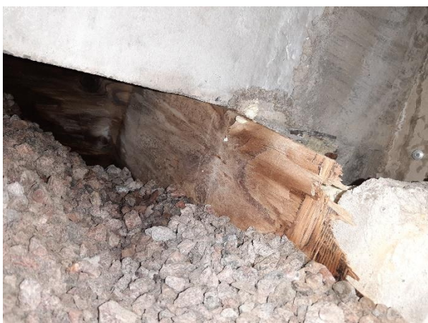
Kuva 3. Alapohjaan on jätetty orgaanista materiaalia, joka on aistivaraaisesti vaurioitunut. Materiaali suositellaan poistettavaksi.
