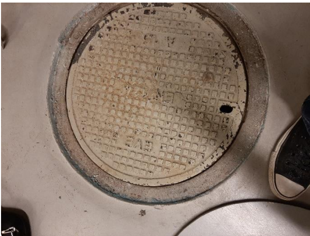
Kuva 7. Väestönluokan luukku on epätiivis.
