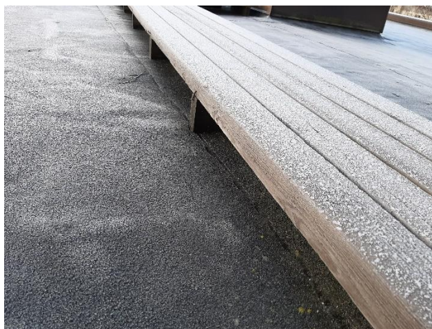
Kuva 22. Kattosillan tukien alta puuttuu laakerikerros.
