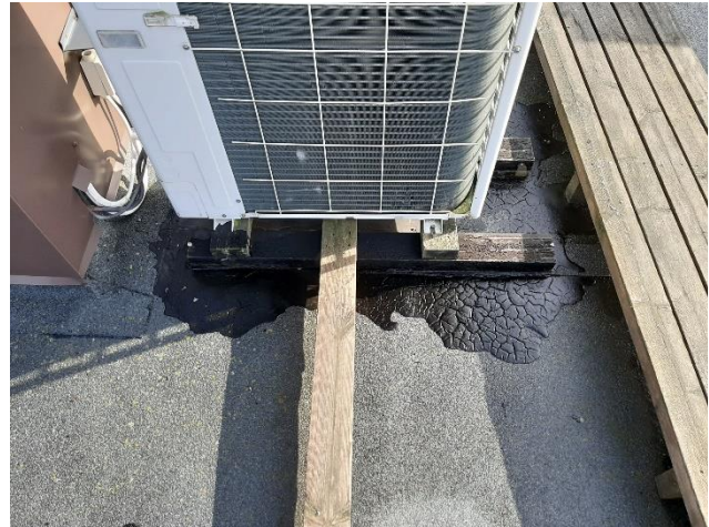
Kuva 24. Lauhduttimen jalka on liimattu bitumilla kattopintaan.
