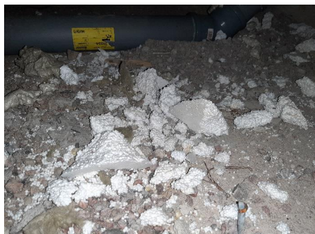
Kuva 4. Alustatila on hieman epäsiisti, ylimääräiset rakennusjätteet suositellaan poistamaan.
