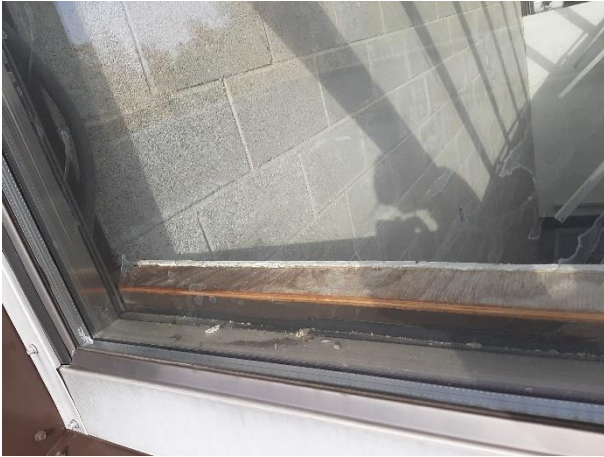
Kuva 27. Puussa kosteusjälkiä, kattoikkuna.
