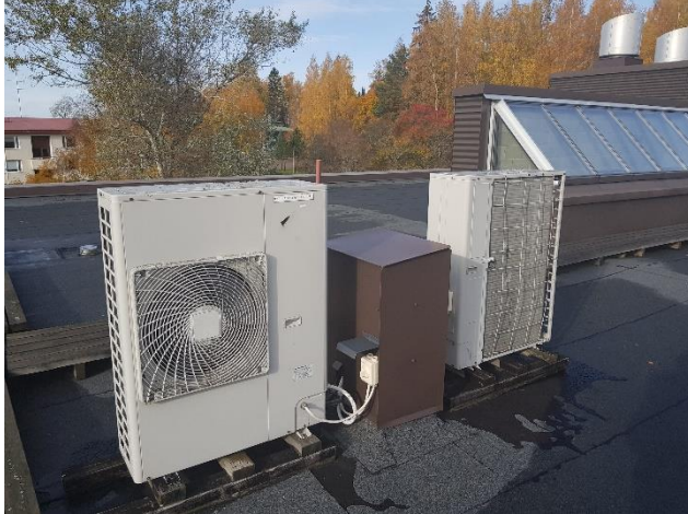
Kuva 23. Sisäilman lauhduttimien ulkoyksiköitä.
