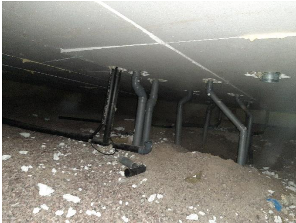
Kuva 5. Ei pystysuorat viemärit tulisi kannakoida.
