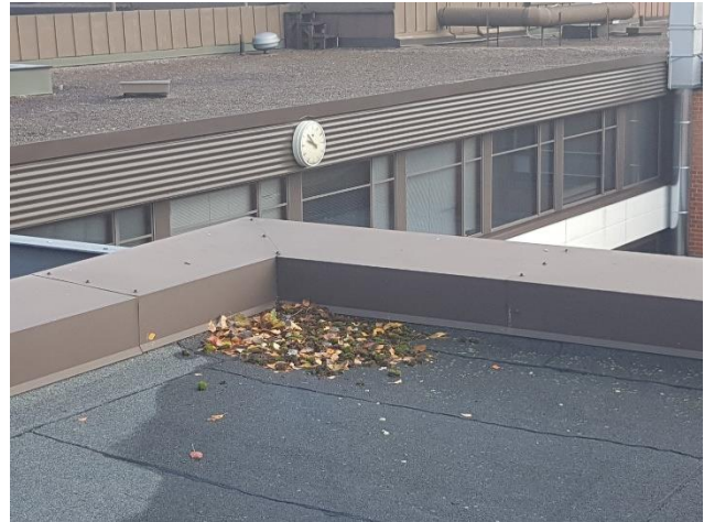
Kuva 15. Sammaleen lisäksi kattopinnalla oli puista pudonneita lehtiä.
