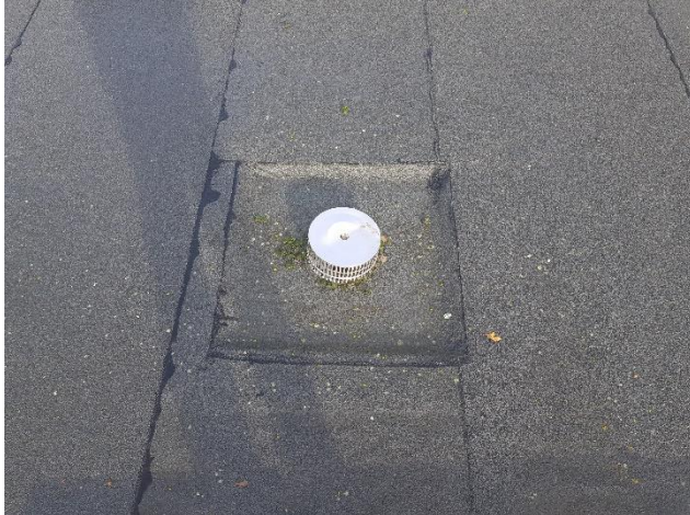
Kuva. 18 Kattokaivo sijaitsee syvennyksessä. Kaivo on varustettu lehtisihdillä.
