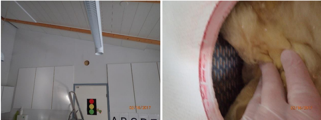
Kuvat 11 ja 12. Tilan 142 varaston 139 yläpuolinen ullakkoon rajoittuva seinä.
