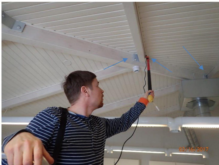
Kuva 3. Kaasuanalysointorin anturi jatkovarren päässä katon liitoskohdassa.
