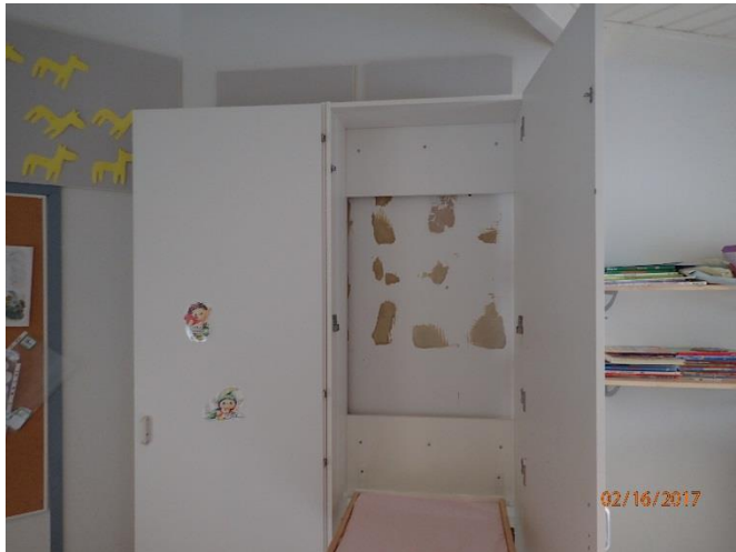
Kuva 2. Seinän liimajäämissä oli näkyvää lasivillaa.
