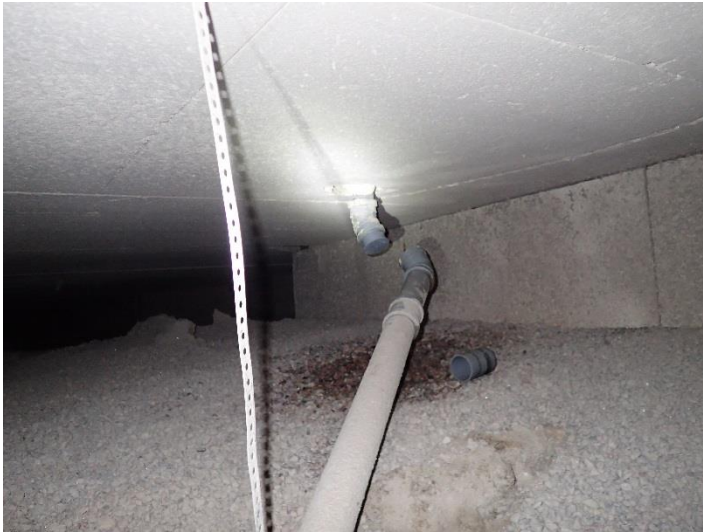
Kuva 15. Entisen vesileikkihuoneen tulpattu viemäriputki ja kostea sepeli sillä kohdin.
