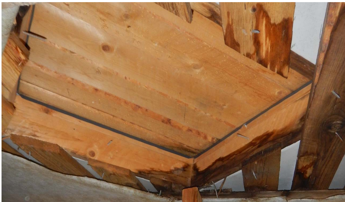
Kuva 56. Kattoluukun kohta oli toteutettu huonosti.
