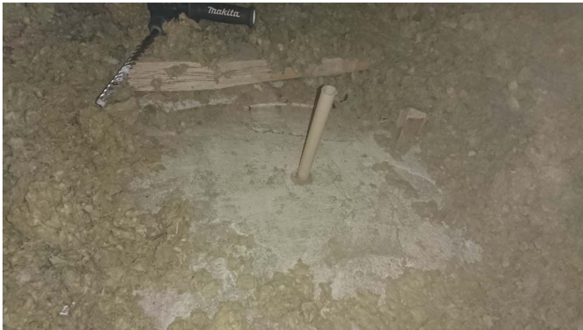
Kuva 53. Vanhaan eristetilaan oli tehty ilmeisesti kosteusmittauksia aikaisemmin.
