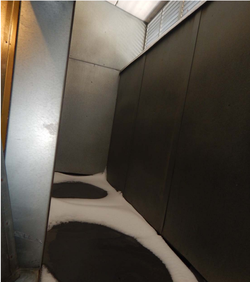
Kuva 64. Tuloilmakammioon pääsi lunta.
