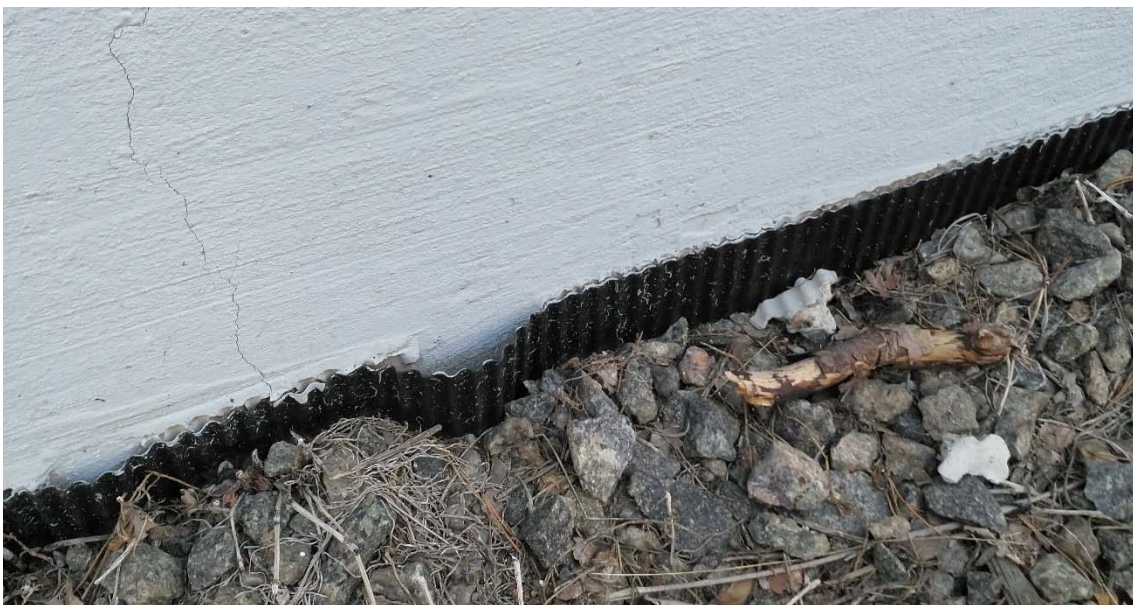
Kuva 11. Laajennuksen sokkelin ulkopuolisen kosteuseristyksen yläosa ei ollut tiivis.
