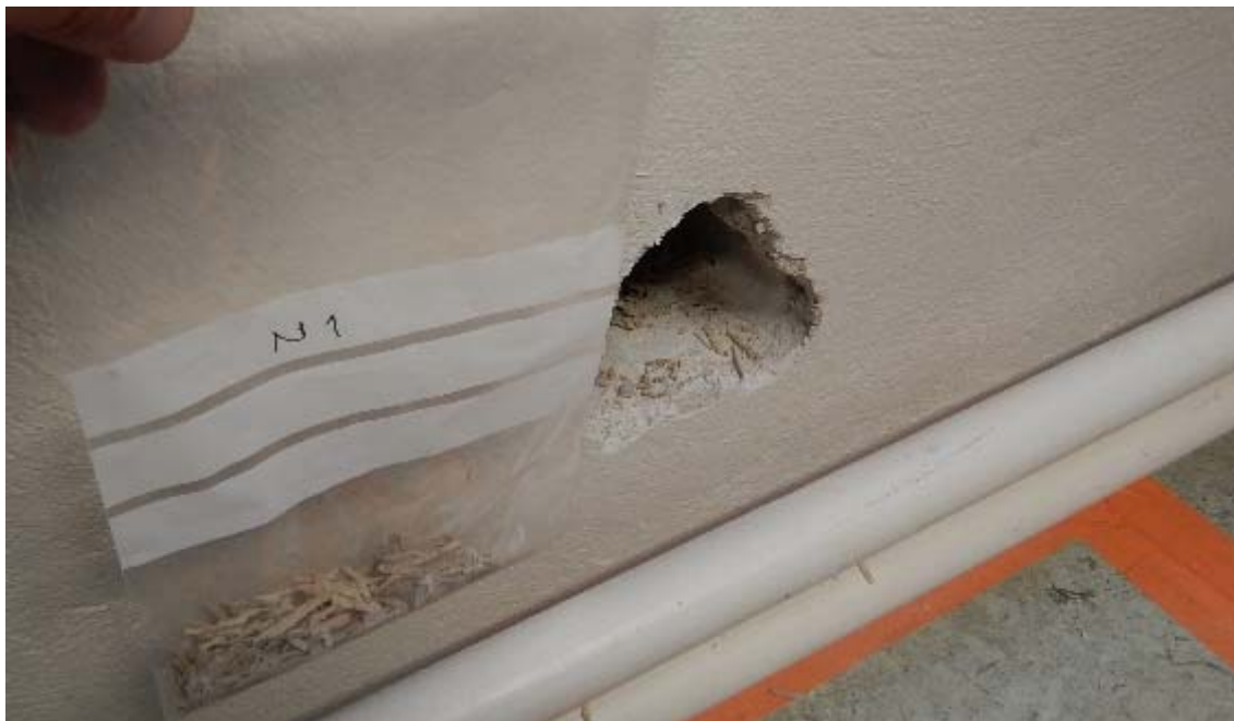
Kuva 25. Varastotilan maanvastaisen seinän ala-osan tojalevystä otettiin materiaalinäyte (N1) mikrobitutkimuksiin. Näytteessä viite mikrobivauriosta.
