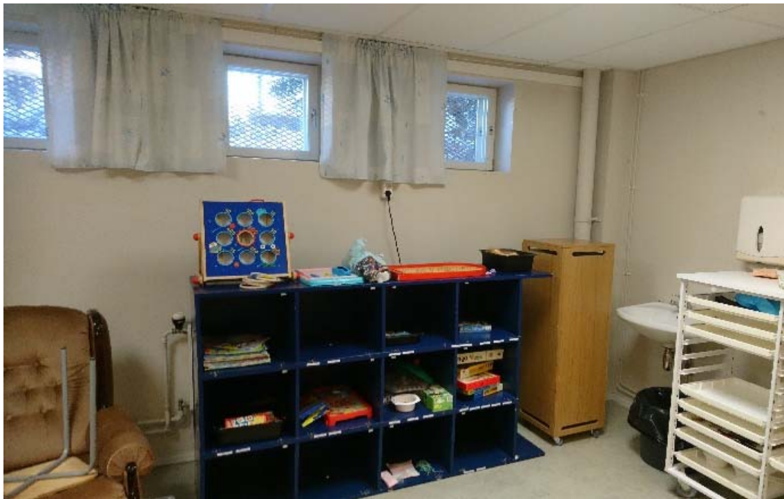
Kuva 57. Puiset ikkunat kellarikerroksessa heikkokuntoisia.
