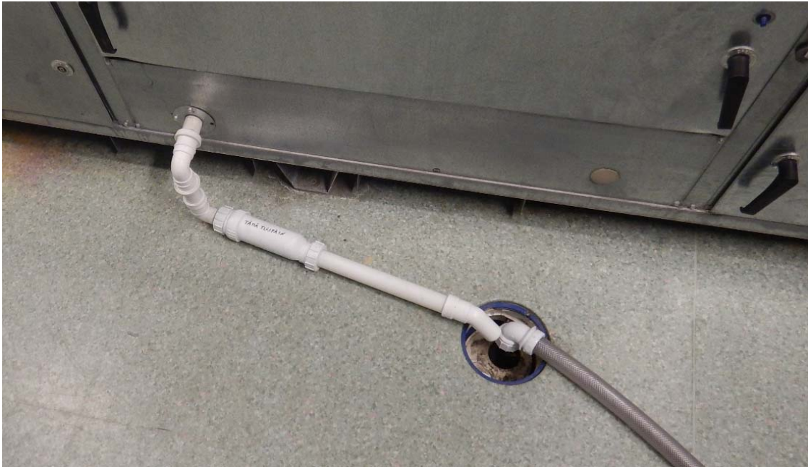
Kuva 63. IV-koneen kondenssivedet oli johdettu oikeaoppisesti lattiakaivoon.
