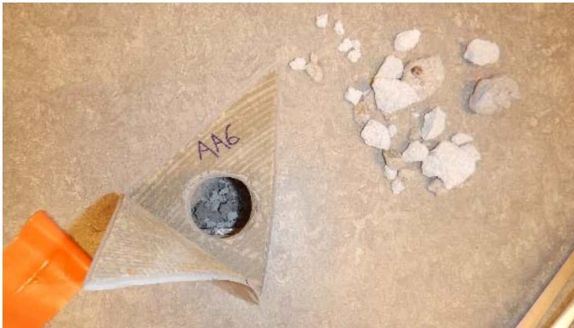
Kuva 18. Lattiaan poratussa tutkimusreiässä eristeenä kevytsoraa. Kevytsorasta otetussa näytteessä N11 vahva viite mikrobivauriosta.
