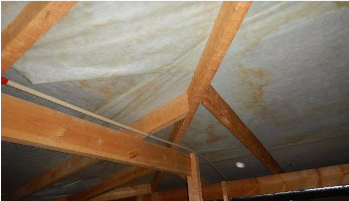
Kuva 54. Aluskatteessa on vuotojälkiä runsaasti
