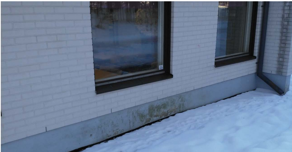
Kuva 10. Laajennuksen sokkelirakenteen maalipinta oli huonossa kunnossa.
