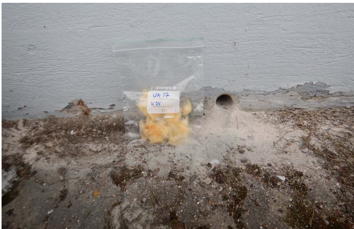
Kuva 33. Näyte N35 otettiin "valesokkelin" sisältä, seinän alaosasta.
