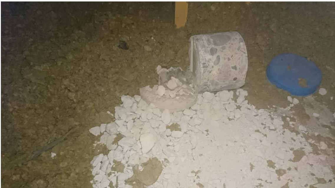
Kuva 52. Yläpohjan vanha kevytbetonieriste löytyi betonilaattojen välistä.
