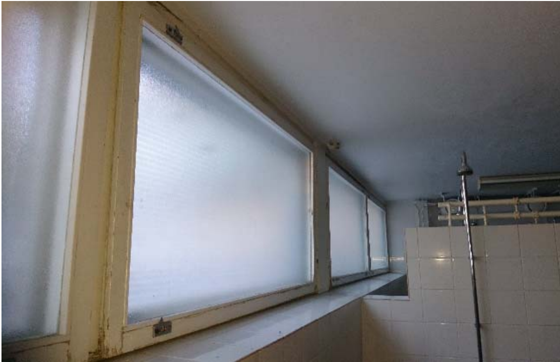
Kuva 62. Kellarikerroksen pesutilojen ikkunat olivat heikkokuntoisia.
