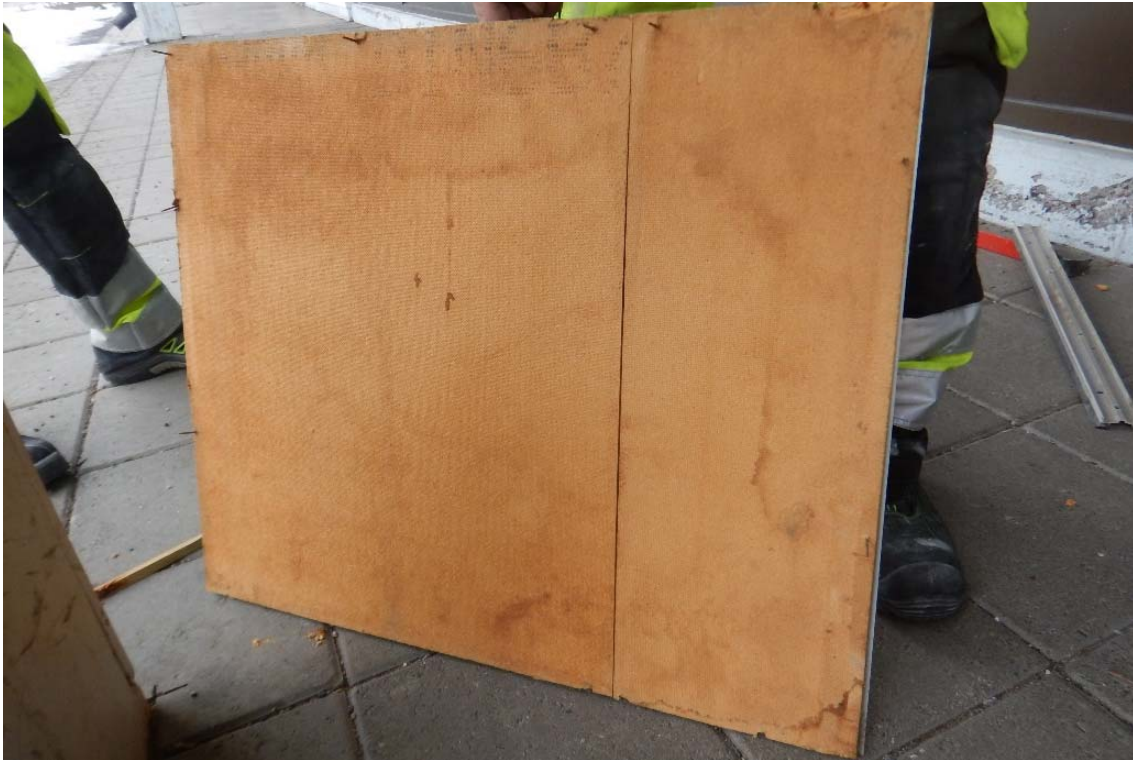
Kuva 43. Ikkunoiden alapuolisessa rakenteessa oli merkkejä kosteusvauriosta.
