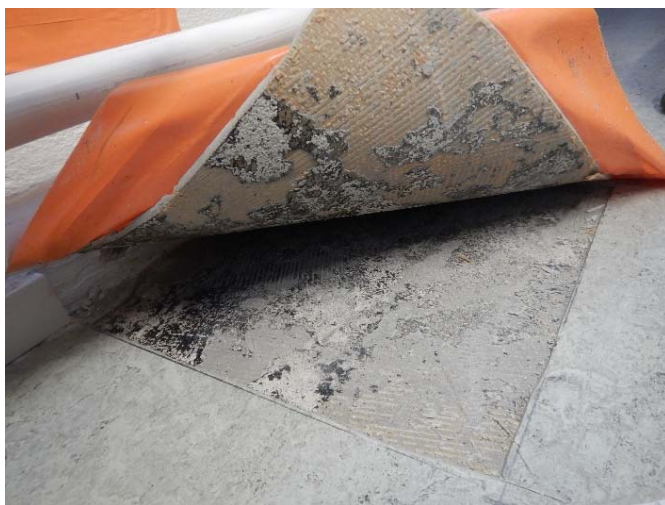
Kuva 16. Asbestipitoinen musta liima kellarin lattiassa.
