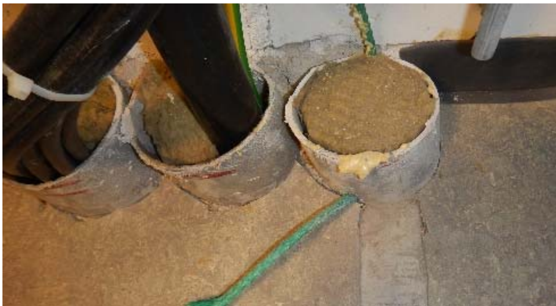
Kuva 19. Alapohjan läpiviennit tiivistämättömiä.
