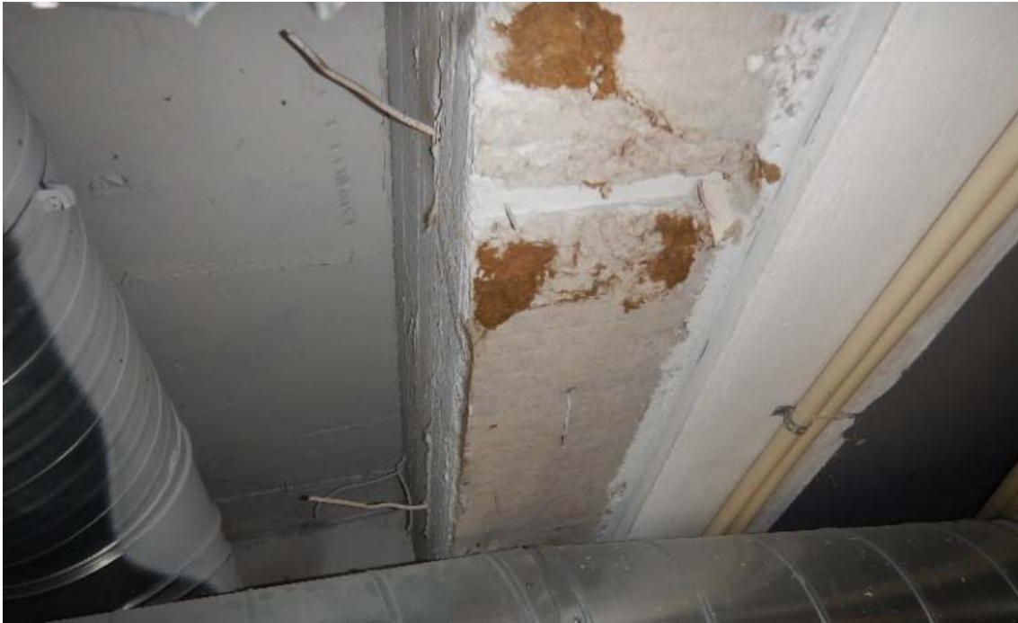
Kuva 48. Vanhan ulkoseinän ulokkeen lämmöneristeenä on käytetty siporexia. Leukapalkin alareunassa eristeenä solumuovin tapaista eristettä, jossa oli mikrobikasvua.
