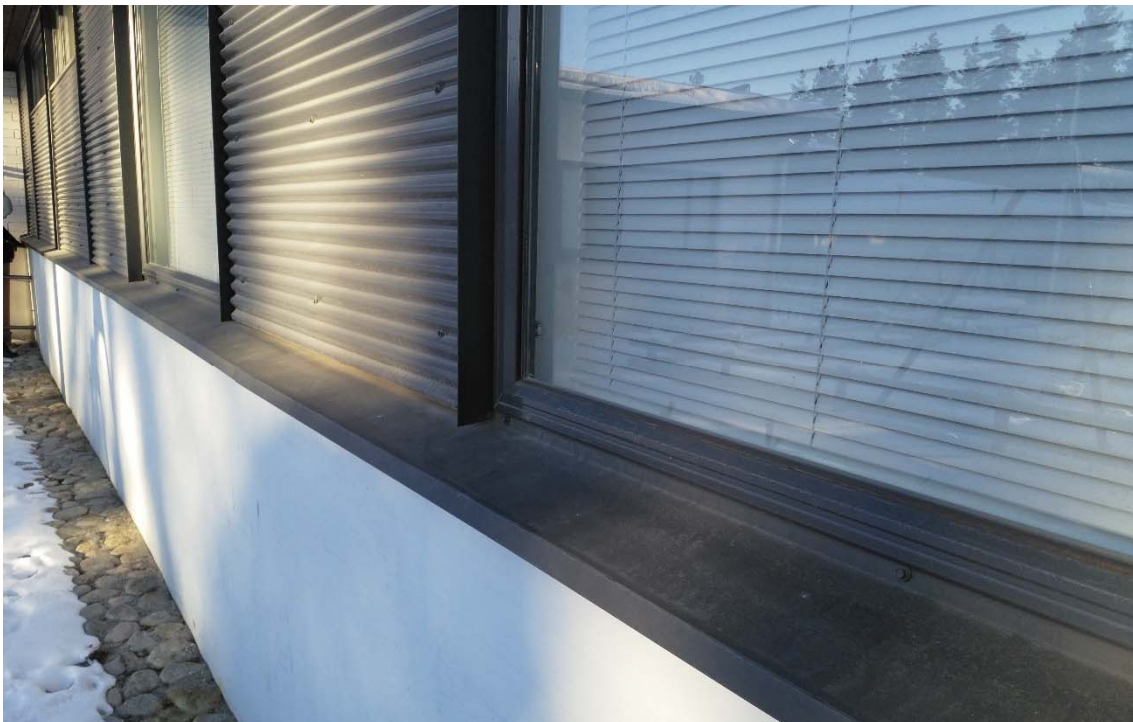
Kuva 60. Etupihan uusittujen ikkunoiden peltien kallistukset olivat riittävät.
