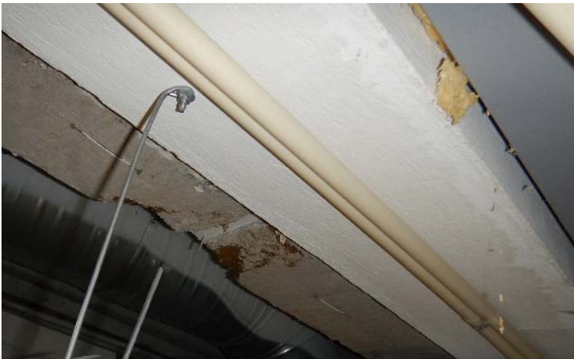
Kuva 49. Leukapalkin kylkeen asennettu teräspalkki uutta rakennusosaa varten. Rakenteiden väli ei ollut tiivis.
