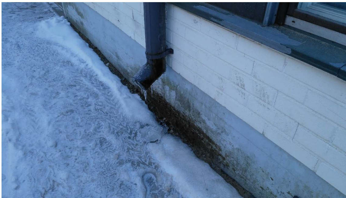
Kuva 7. Takapihalla sadevedet ohjattiin liian lähelle sokkeliä. Sokkeli oli vaurioitunut.
