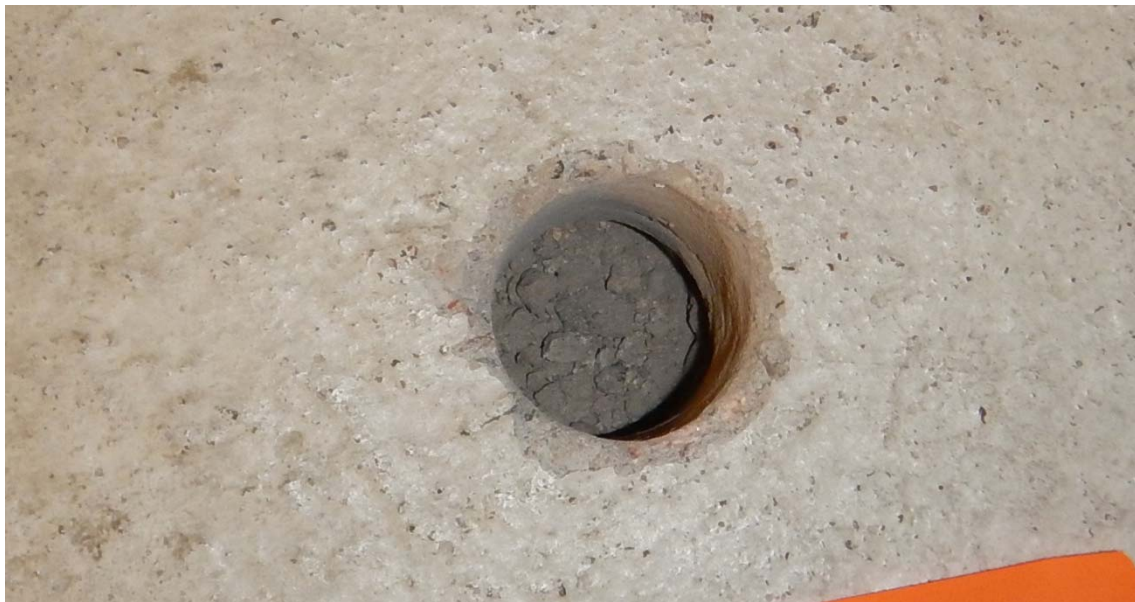
Kuva 15. Alapohjaan tehtiin muutamilla osilla rakennetarkistus ja alapohjaeristeestä (sipo-rex) otettiin materiaalinäyte. Tekniikka 014 tilassa kevytbetonin tilalla oli hiekkaa.
