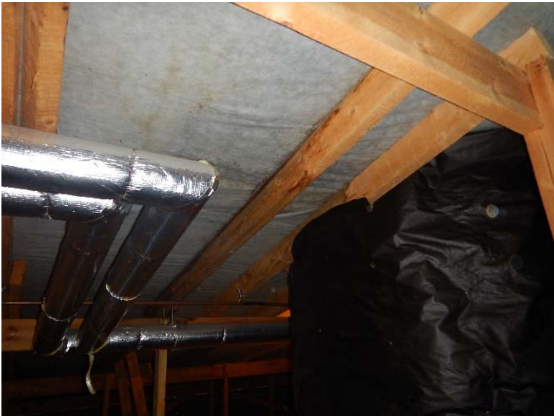
Kuva 55. Valokuilujen eristeenä mineraalivillaa ja vuoraus tervapaperilla.
