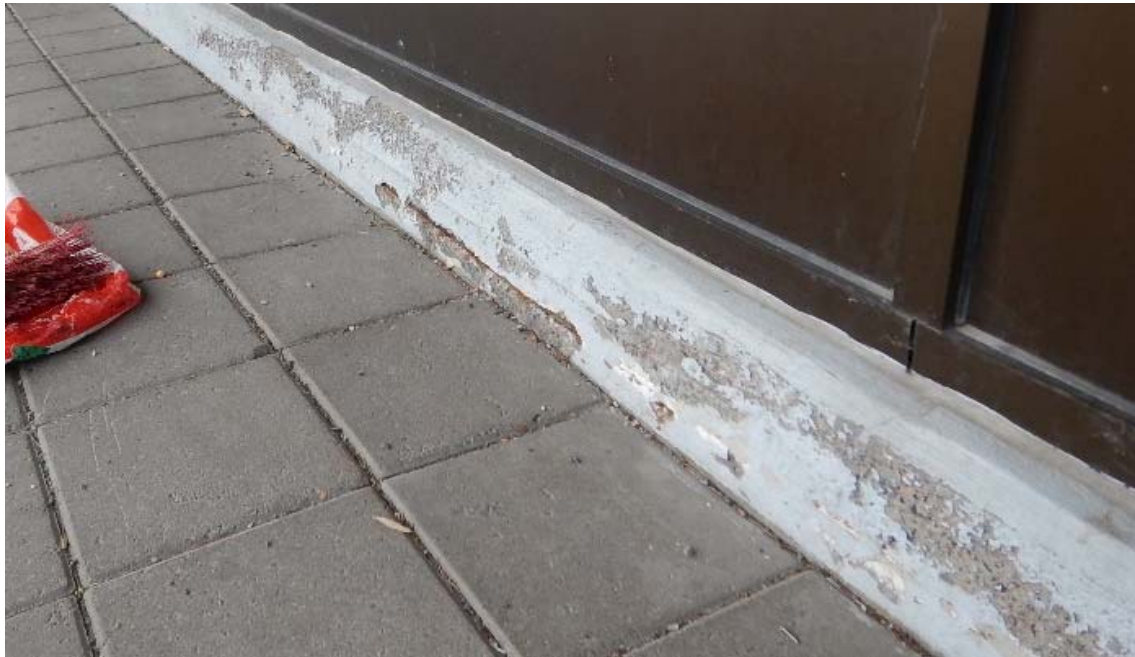
Kuva 6. Sisääntulon vierustainen sokkeli rapautunut ja raudoitus näkyvissä.
