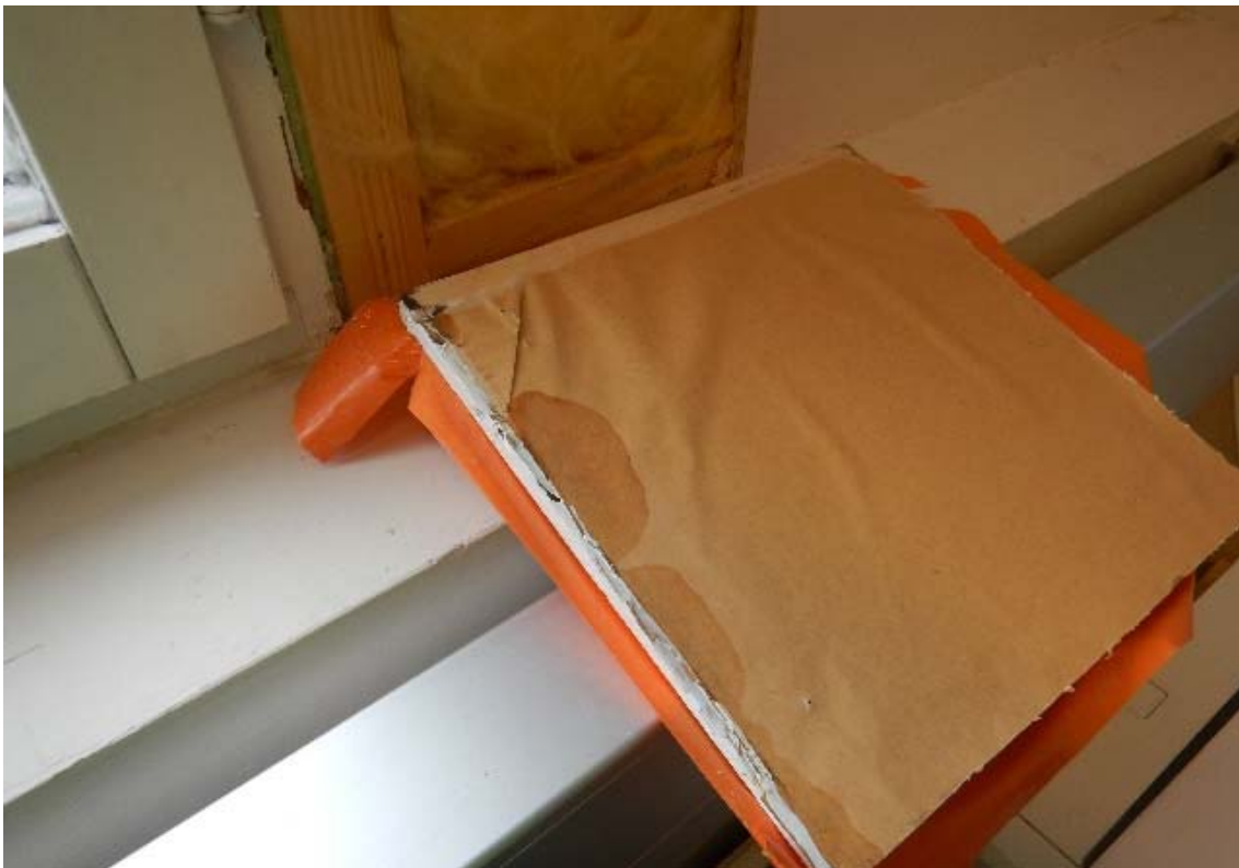
Kuva 40. Ikkunanauhojen ulkoseinärakenteen ilmansulkupaperissa oli kosteusjälkiä.
