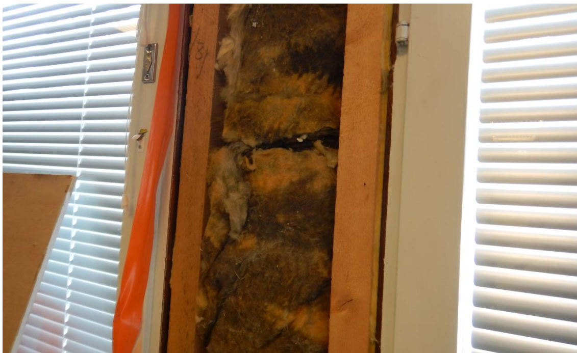
Kuva 39. Osaan tiloista ikkunauhojen väleihin oli jätetty vanhat eristeet ikkunoiden uusimisesta huolimatta.
