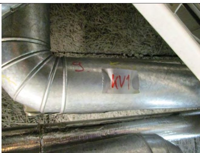
KV1: Pohjakerros, Lämmönjakuhuonetila 0.54; Kv-runkolinja tilan katon rajassa 63/2,0 mm.
