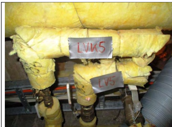
LV5: Kellarikerros, Putkikanaali; Lv-runkohaara lähellä kanaalin katon rajaa 28/1,2 mm
