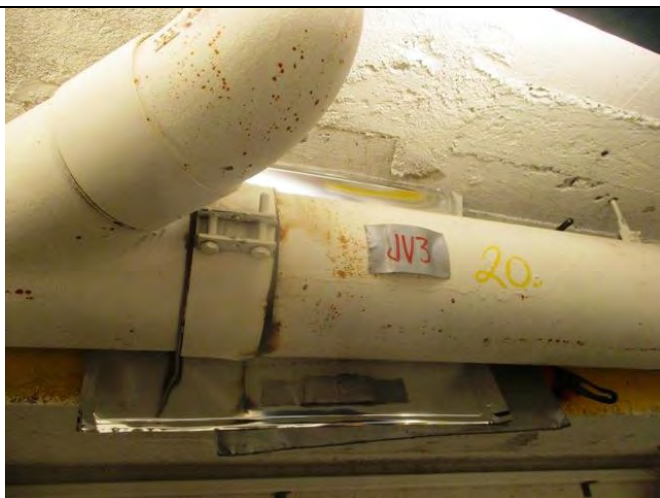
JV3: Alakellari, Varastotila K15; Jv-viemäri- linjan vaakaputkiosat tilan katon rajassa 160/5,0 mm.
