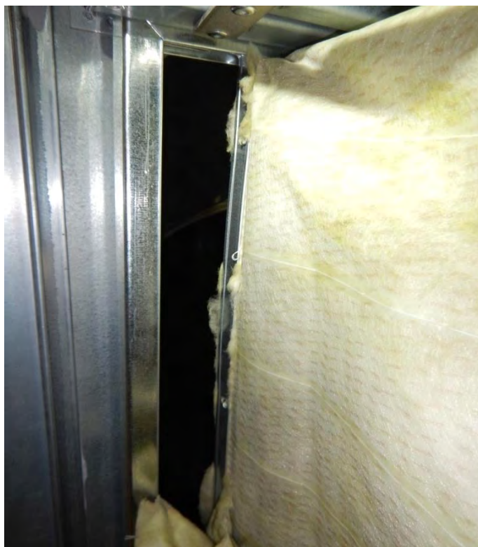
Kuva 34. Suodattimesta (poisto) on repeytynyt kokonainen pussi irti.
