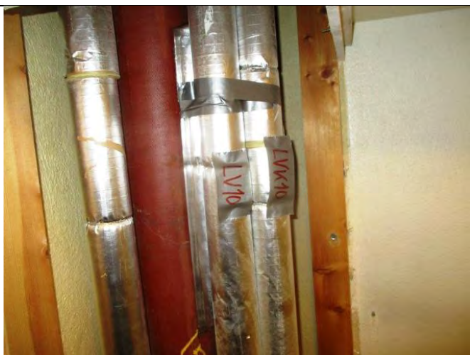
LV10/LVK10: 1. kerros, F-porrashuoneen yhteydessä siivousskomerotila; Lv-runkohaara tilan seinustalla koteloinnin "suojassa" 18/1,0 mm & (lvk) 12/1,0 mm.
