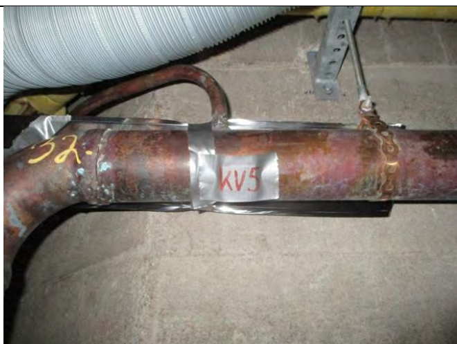
KV5: Kellarikerros, Putkikanaali; Kv-runkolinja kanaalin seinustalla lähellä vesi- mittaria 76/2,0 mm.
