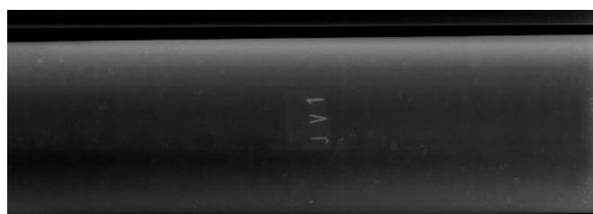
JV1: Jv-viemäriin suora pystyputkiosasta ei havaittu syöpymiä.
