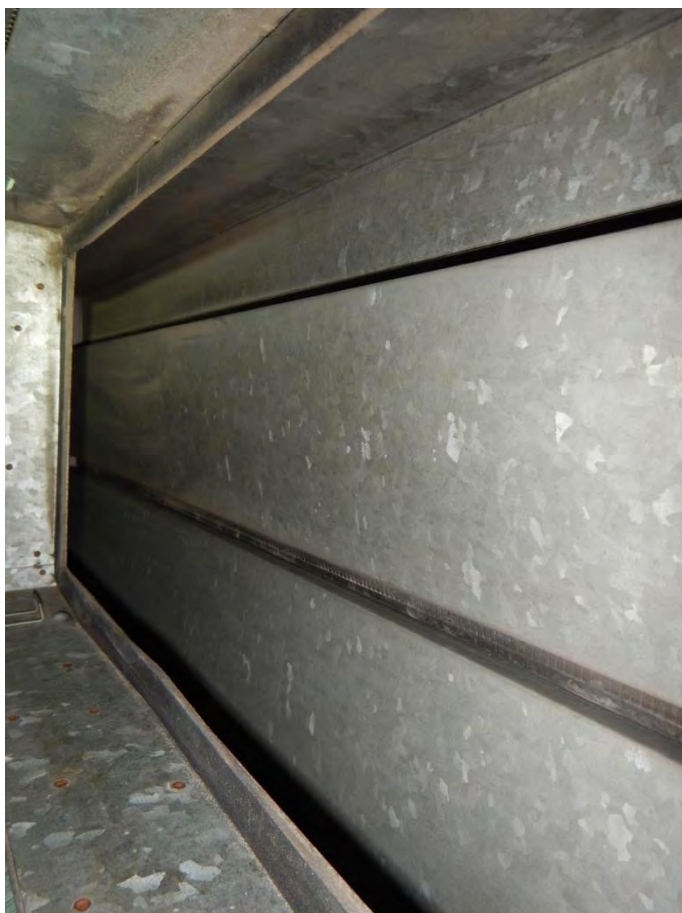
Kuva 19. Raitisilmapelti ei sulkeudu kunnolla.
