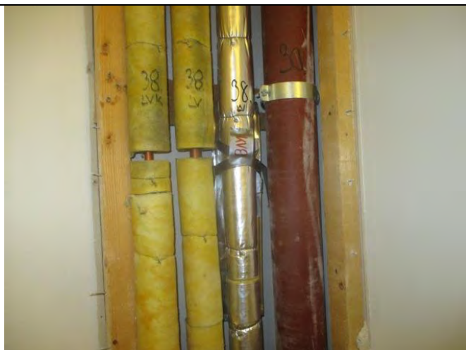
KV8: 1. kerros, Invalidien wc-tila A1.35; Kv-runkohaara tilan seinustalla koteloinnin "suojassa" 35/1,5 mm.
