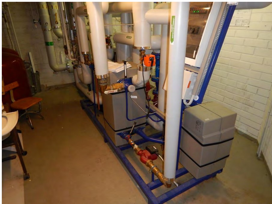
Kuva 1. Yleiskuva lämmönjakohuoneen laitteista.
