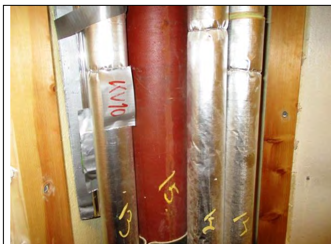
KV10: 1. kerros, F-porrashuoneen yhteydessä siivouskomerotila; Kv-runkohaara tilan seinustalla koteloinnin "suojassa" 15/1,0 mm.
