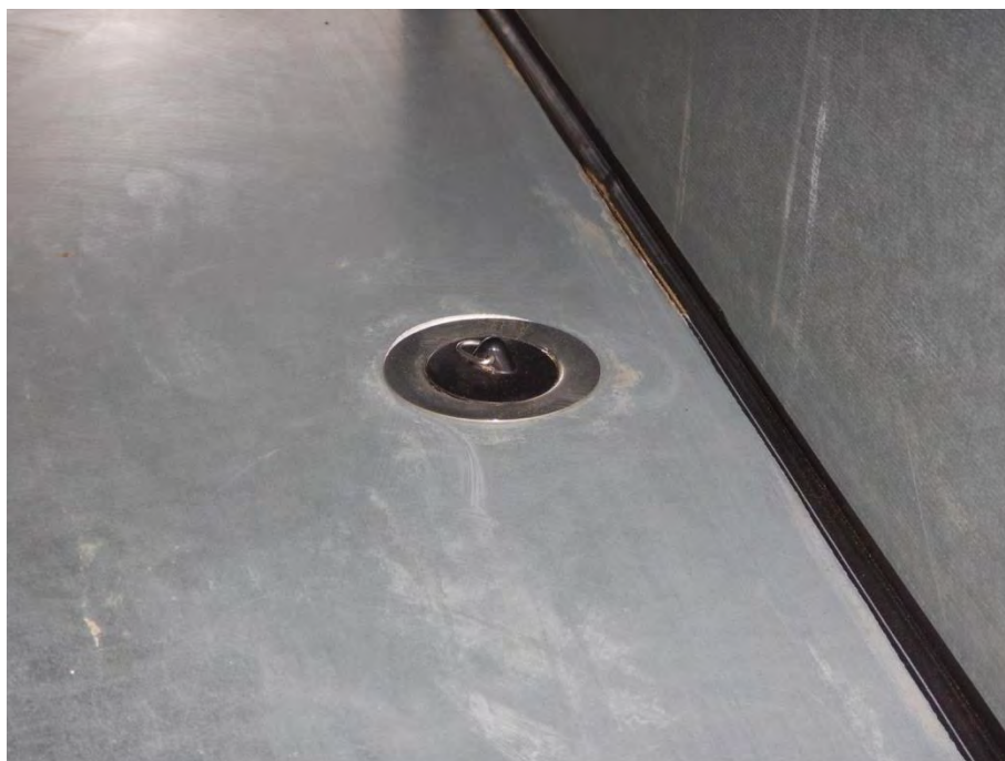
Kuva 44. Koneen vedenpoisto on tulpattu.
