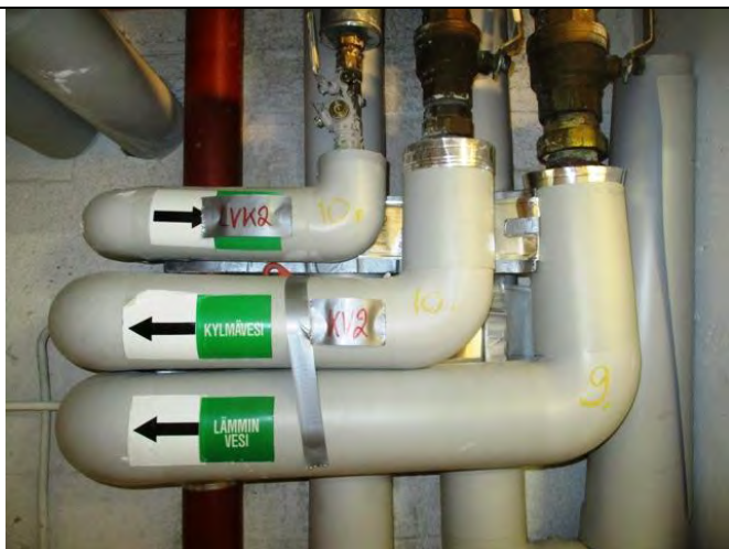
KV2: Pohjakerros, Lämmönjakohuonetila 0.54; Kv-runkohaara tilan seinustalla 42/1,5 mm.
