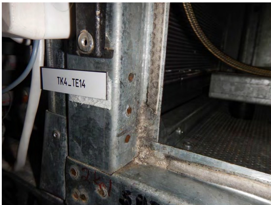
Kuva 28. Kammioiden tiivisteet ovat huonossa kunnossa.
