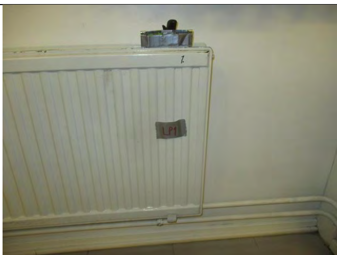
LP1: 3. kerros, Luokkatila A304; 2-lamellinen teräslevypatteri tilan ulkosein- tällä, ilmausruuvin laidalta, s = 1,5 mm.
