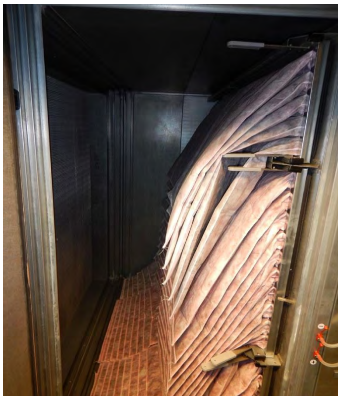
Kuva 33. Tulosuodattimien asennussuunta on väärä.
