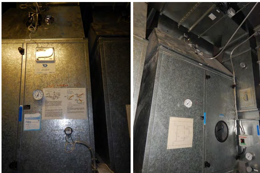
Kuva 13. Yleiskuva TK1/PK1 koneesta.
