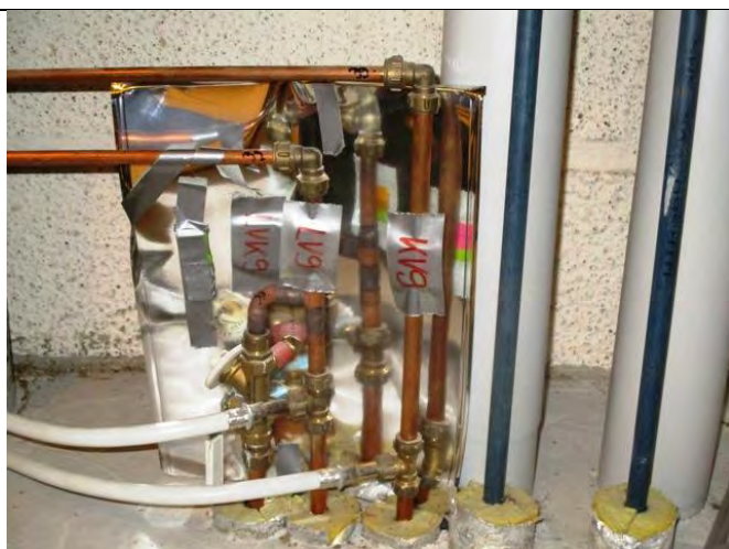
KV9: 3. kerros, lv-konehuonetila B3.06; Kv-nousulinja tilan seinustalla lähellä lattia rajaa 15/1,0 mm (uudempaa putkitusta vuo- delta 1999!).
