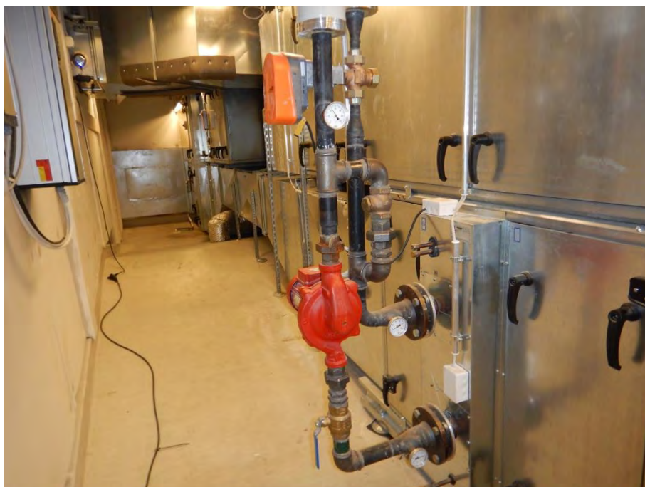
Kuva 39. Yleiskuva TK8/PK8 koneesta.
