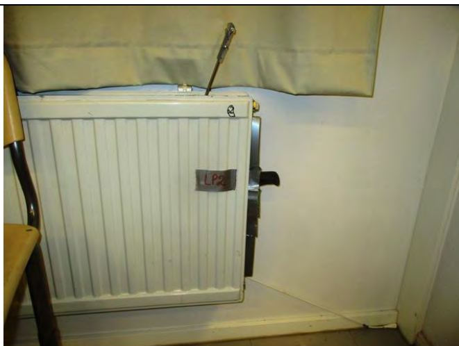
LP2: 3. kerros, Luokkatila A301; 2-lamellinen teräslevypatteri tilan ulkoseinustalla, ilmausruuvien laidalta, s = 1,5 mm.
