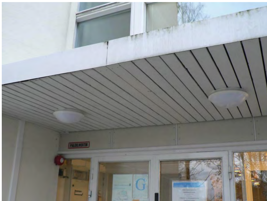
S-kuva 2. Yleiskuva sisäänkäyntikatokseen asennetuista valaisimista.
