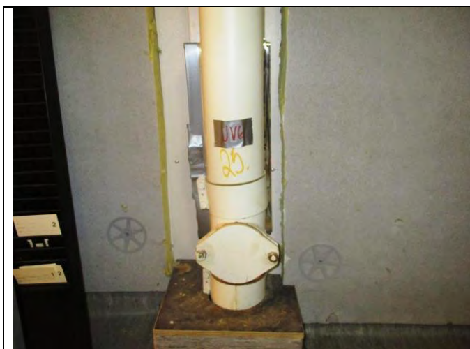
JV6: Pohjakerros, Iv-konehuonetila 0.40; Jv-viemäriinlinjan pystyputkiosat tilan seinustalla lähellä lattiaa 110/5,0 mm.
