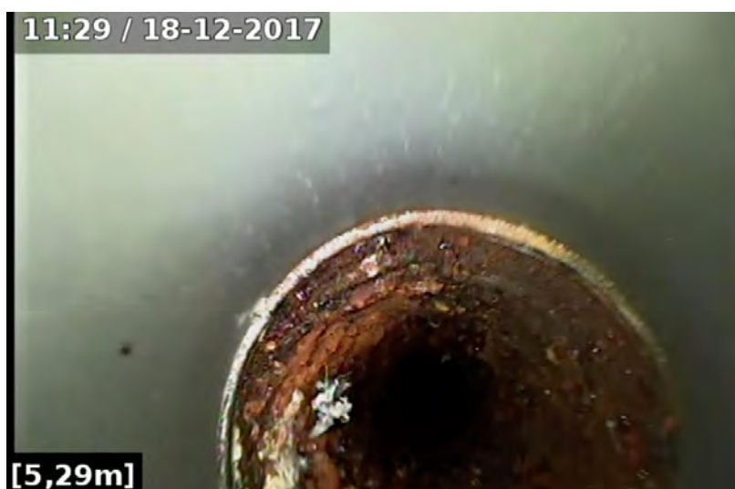
Kuva 10. Valurautainen viemäriosuus on syöpynyt.
