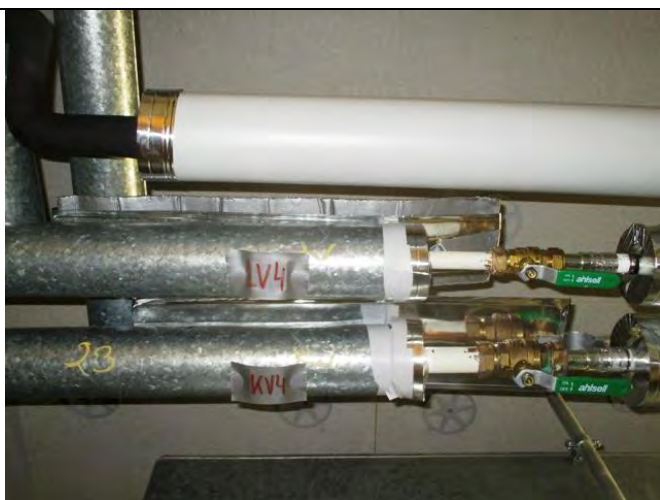
KV4: Pohjakerros, Iv-konehuonetila 0.40; Kv-runkohaara tilan katon rajassa 28/1,2 mm.
