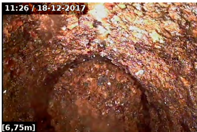
Kuva 9. Viemäri on tukossa korroosiokertymästä.
