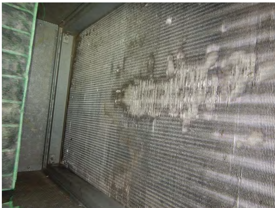
Kuva 27. LTO-patteri on kolhiintunut ja reuna-alueilla on epäpuhtauksia.
