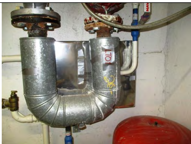
LTO1: Pohjakerros, Iv-konehuonetila 0.40; LTO-verkoston runkolinja tilan seinustalla lähellä kiertovesipumppua 60,3/3,0 mm & 21,3/3,25 mm (liittyy keittiötilaa palvelevaan tuloilmakoneeseen TK4).
