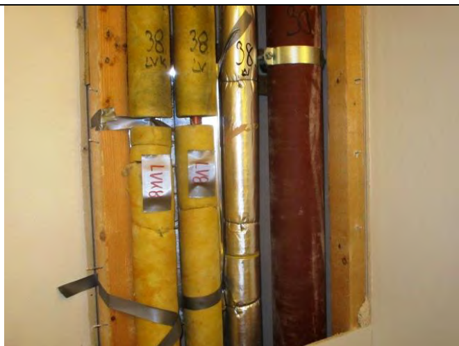
LV8: 1. kerros, Invalidien wc-tila A1.35; Lv-runkohaara tilan seinustalla kotelossa 22/1,0 mm.
