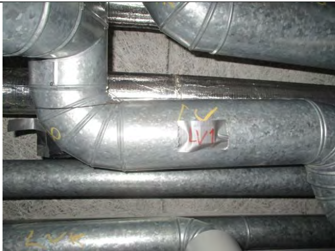
LV1: Pohjakerros, Lämmönjakohuonetus 0.54; Lv- runkolinja tilan katon rajassa lähellä lv-siirrintä 54/1,5 mm.
