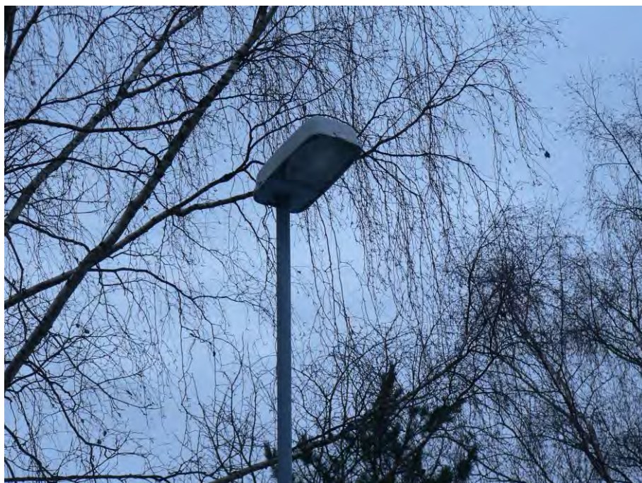
S-kuva 1. Rakennuksen länsipuolella sijaitseva pylväsvalaisin.
