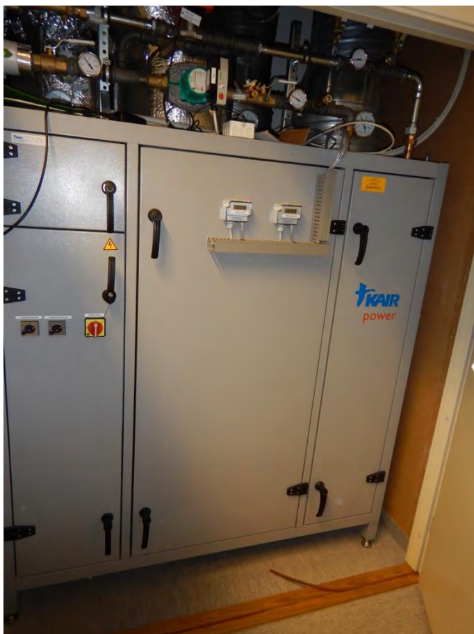
Kuva 42. Yleiskuva TK/PK9 koneesta.
