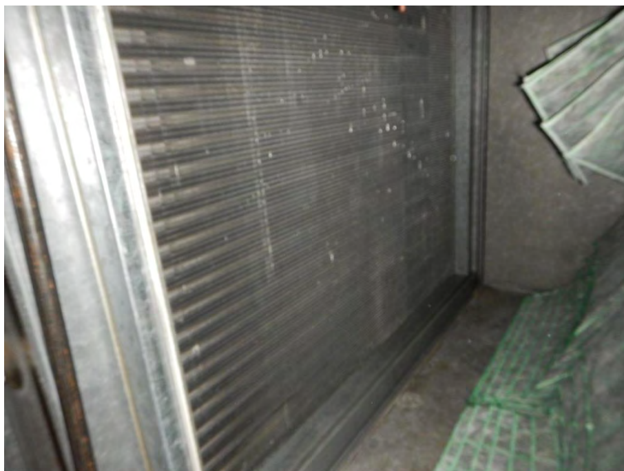
Kuva 21. Lämpöpatteri on kolhiintunut.
