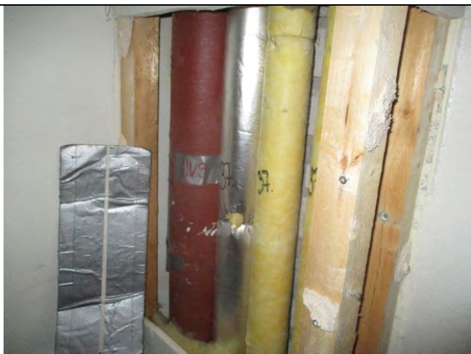
JV9: 1. kerros, Siivouskomerotila A1.16; Jv-viemäriin suora pystyputkiosa tilan seinustalla koteloinnin "suojassa" 110/5,0 mm.
