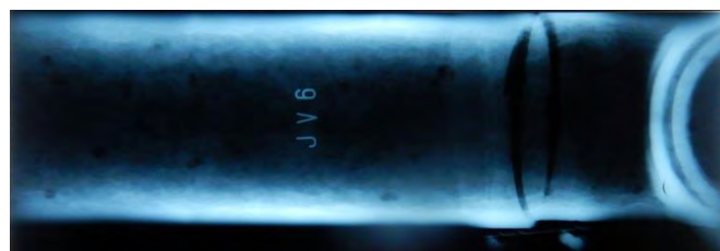
JV6: Jv-viemäriinlinjan pystyputkiosissa erottuu laaja-alaista syöpmää < 30 % seinämän pak-suudesta. Jäljellä oleva seinämäpaksuus on noin 3,5 mm. Kuvatulla putkiosuudella on yksittäisten valuhuokosten kohdilla pistemäisesti huomattavastikin pidemmälle edenneitä putkiseinämän syöpmävaurioita . Kuvausalueen putkiosien kohdilla putkiseinämien syöpmäinen on laminaarisesti edennyt. Kuvausalueella putkilinjan sisällä erottuu kohtalaisesti sakkakertymää. Kuvausalueen pantaliitoksen asennus on epäsymmetrinen.
