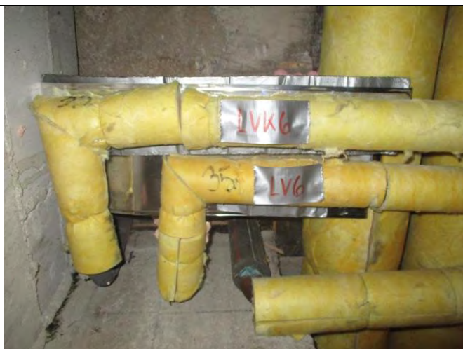
LV6: Kellarikerros, Putkikanaali; Lv-runkohaara lähellä kanaalin katon rajaa 22/1,0 mm.
