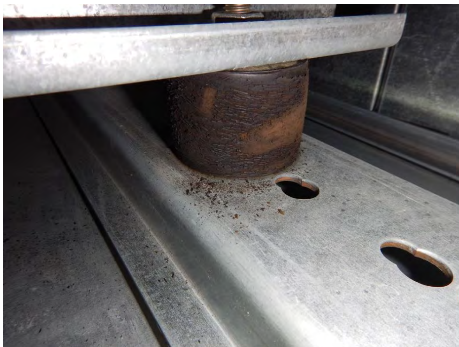
Kuva 41. Tärinänvaimentimet ovat murtuneet.
