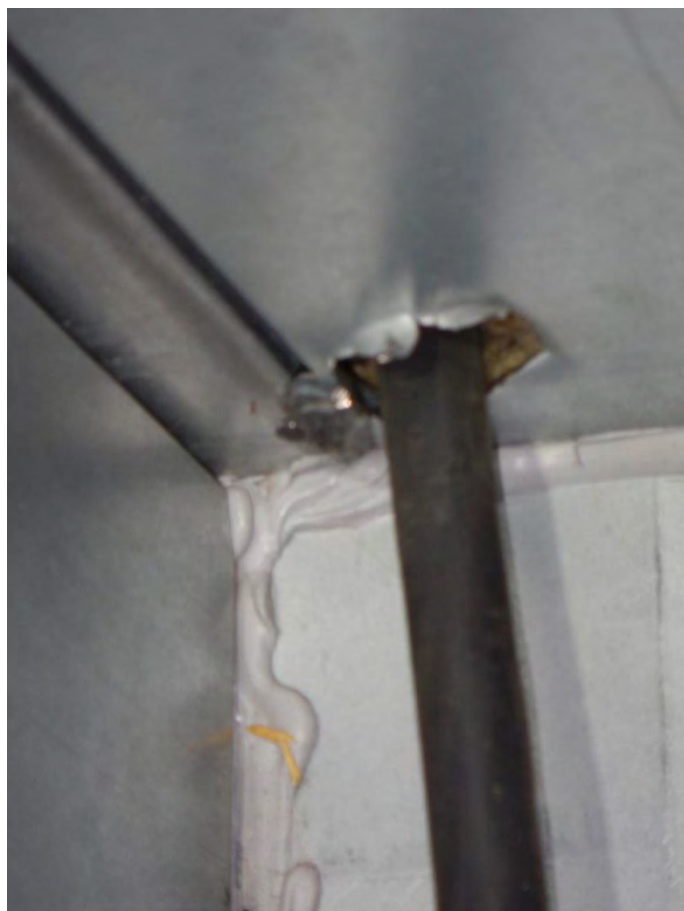
Kuva 38. Läpivienneissä on suojaamatonta mineraalivillaa.
