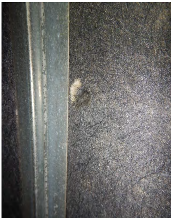
Kuva 40. Äänenvaimentimen lamellin kuitukangas on rikki ja mineraalivillapinta on suojamatta.
