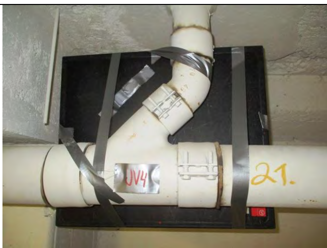
JV4: Alakellari, Varastotila K14; Jv-viemäriinjan vaakaputkiosat lähellä tilan katon rajaa 110/5,0 mm & 75/4,0 mm.
