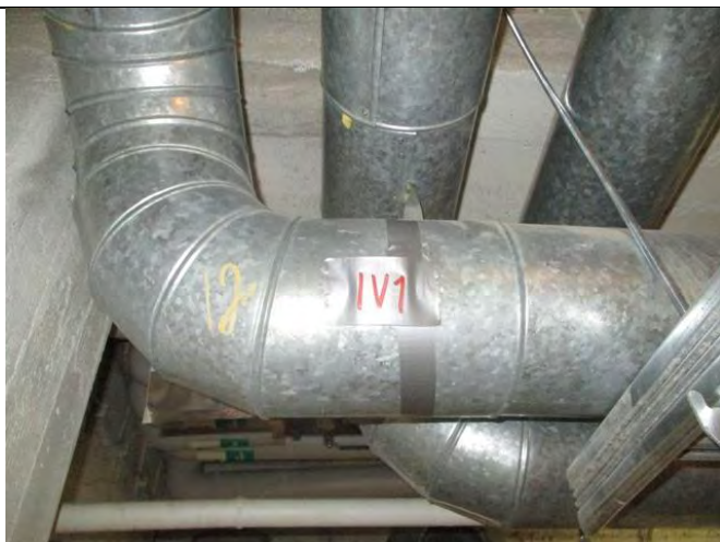
IV1: Pohjakerros, Lämmönjakohuonetila 0.54; Iv-lämmitysverkoston runkolinja tilan katon rajassa, menoputki 88,9/3,2 mm.
