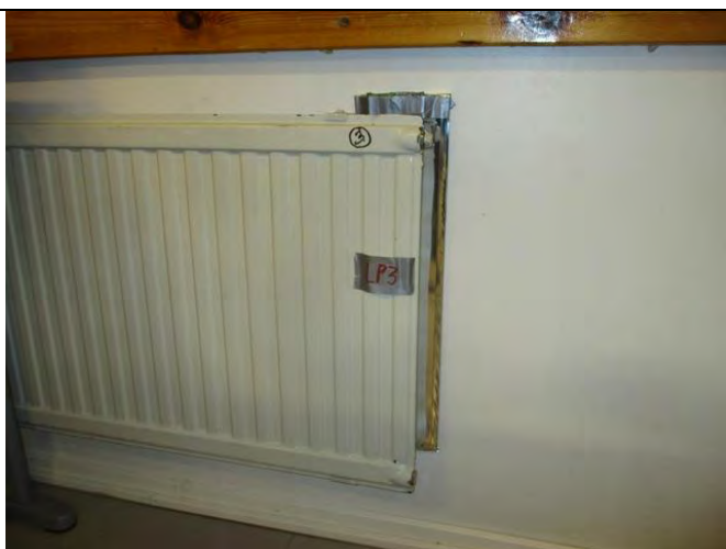
LP3: 2. kerros, Luokkatila B202; 1-lamellinen teräslevypatteri tilan ulkoseinustalla vasemmalla, ilmausruuvien laidalta, s = 1,5 mm.
