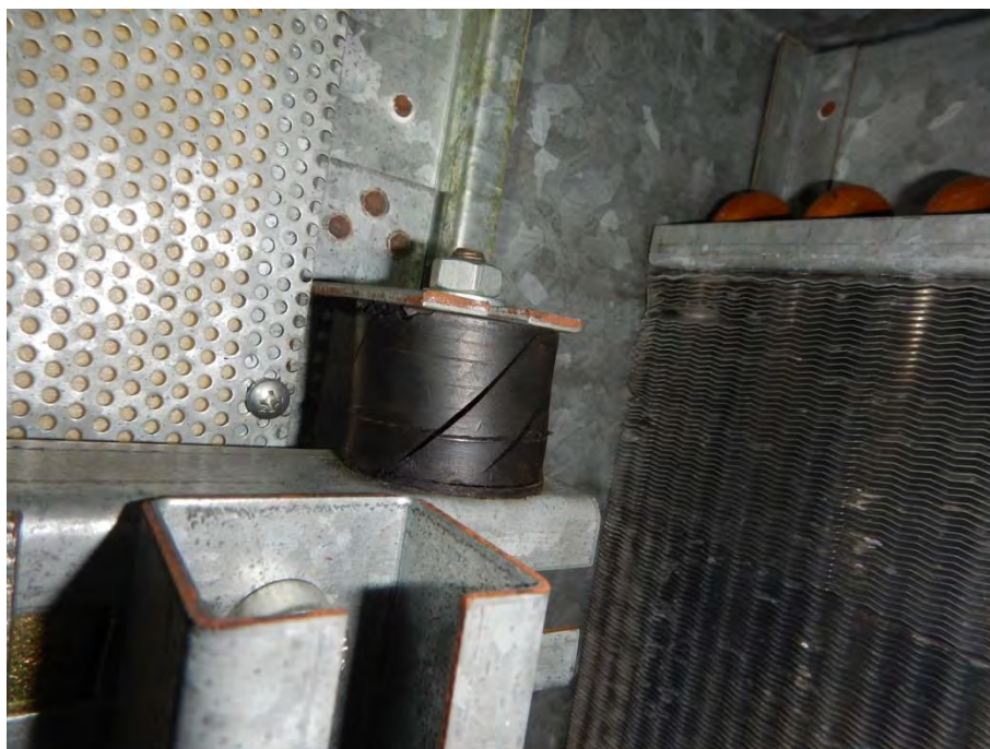
Kuva 25. Puhaltimen tärinänvaimentimet ovat murtuneet.
