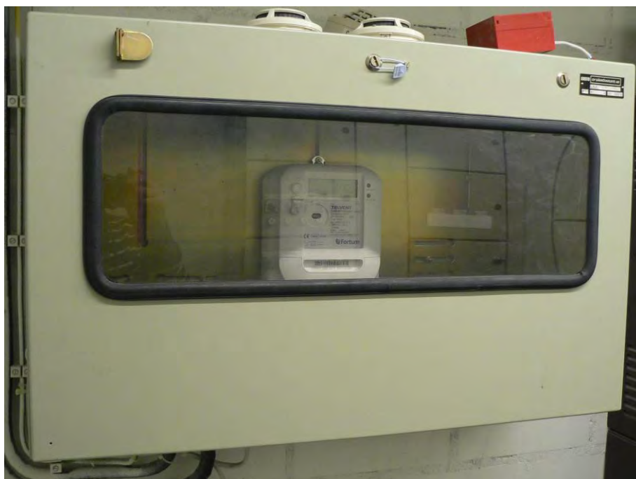
S-kuva 5. Rakennuksen sähköenergian mittaus.
