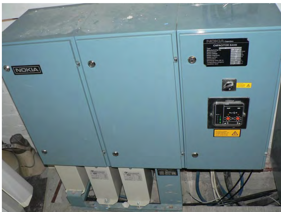
S-kuva 10. Loistehon kompensointiparisto.
