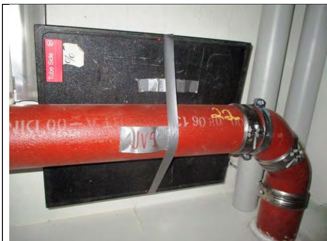
JV5: Pohjakerros, Huoltomiehen varastotila 0.79; Jv-viemäriinlinjan uudemmat vaakaputkiosat tilan katon rajassa 110/4,0 mm (putkilinja asennettu vuonna 2009!).
