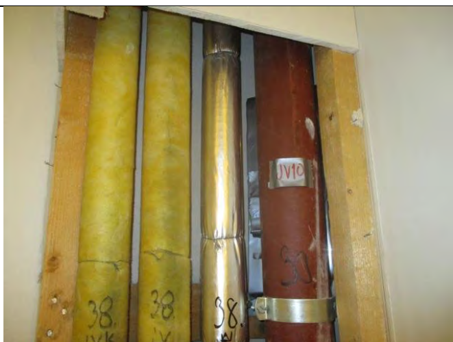
JV10: 1. kerros, Invalidien wc-tila A1.35; Jv-viemäriin suora pystyputkiosa tilan seinustalla koteloinnin "suojassa" 110/5,0 mm.
