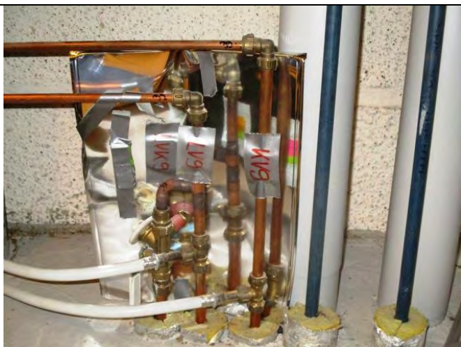
LV9/LVK9: 3. kerros, lv-konehuonetila B3.06; Lv-nousulinja tilan seinustalla lähellä lattian rajaa (uudempaa putkitusta vuodelta 1999!) (lv) 15/1,0 mm & (lvk) 12/1,0 mm.
