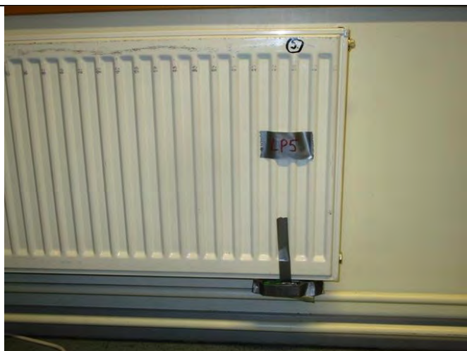
LP5: 2. kerros, Luokkatila A206; 2-lamellinen teräslevypatteri tilan ulkoseinustalla vasemmalla, ilmausruuvien laidalta, s = 1,5 mm (uudempi lämmituspatteri vuodelta 1999!).
