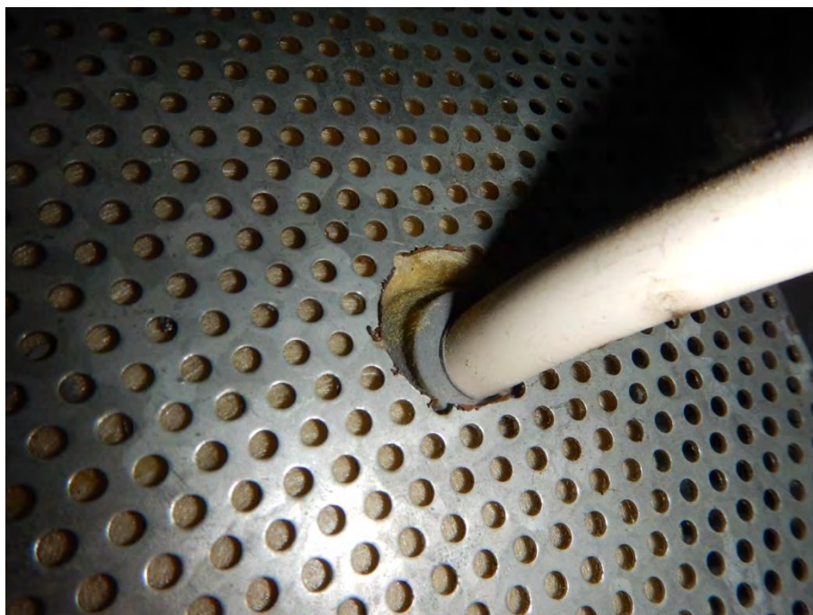
Kuva 24. Läpiviennissä on suojaamatonta mineraalivillaa.
