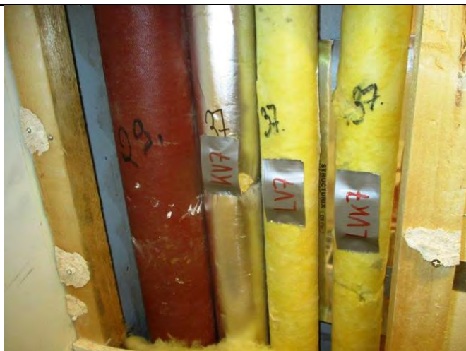
KV7: 1. kerros, Siivouskomerotila A1.16; Kv-runkohaara tilan seinustalla koteloinnin "suojassa" 18/1,0 mm.
