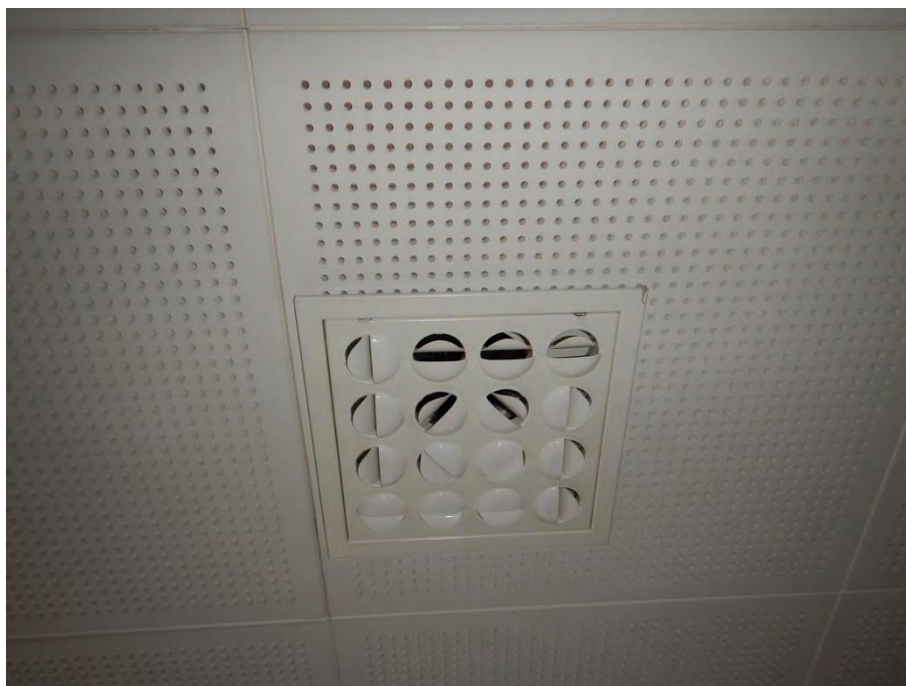
Kuva 51. Yleiskuva pääte-elimistä (uusittu pääte-elin).
