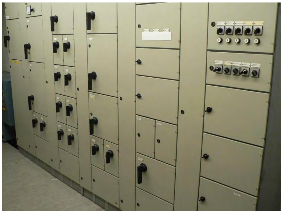
S-kuva 4. Pääkeskus PK.
