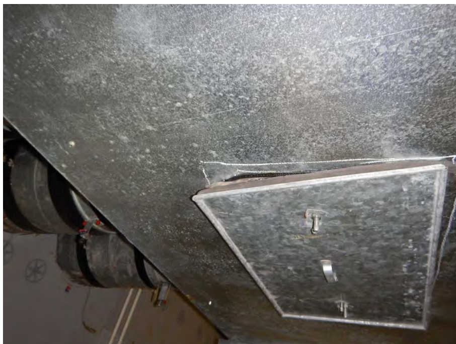
Kuva 31. Äänenvaimennetun kanavan luukku on epätiivis.
