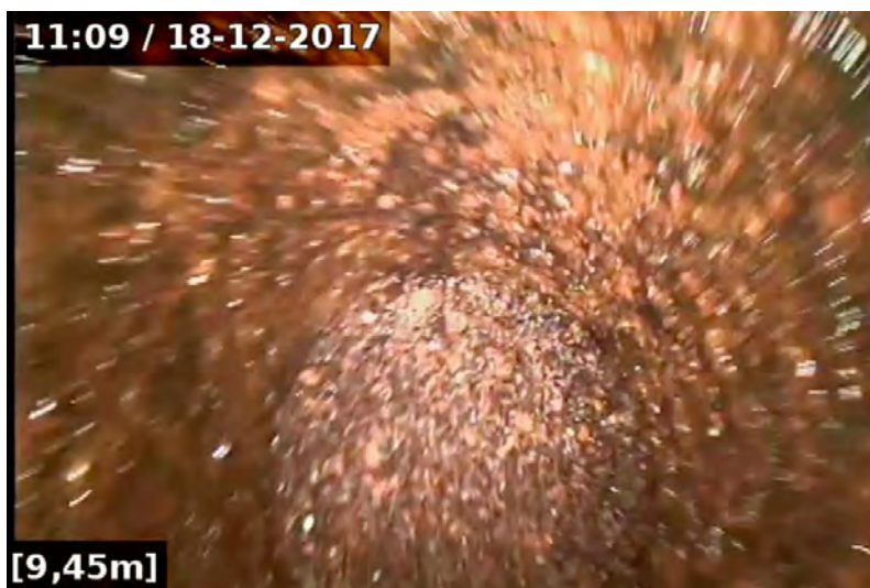
Kuva 7. Tuuletusviemäri on tukossa.
