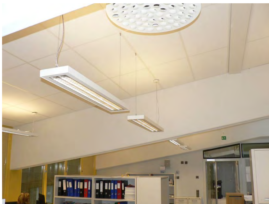
S-kuva 15. Yleiskuva opettajien huoneen valaisimista.
