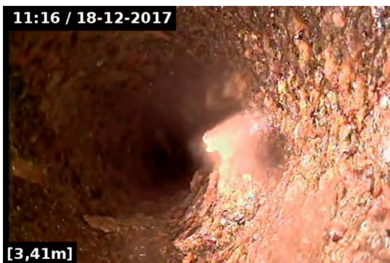
Kuva 8. Viemäriässä on voimakasta korroosiota.
