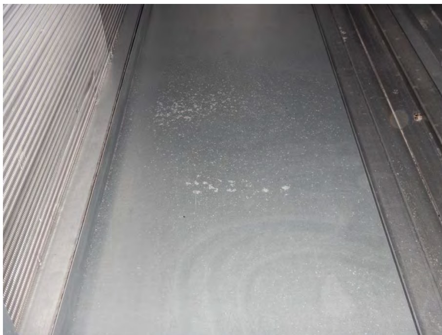
Kuva 37. Kammioissa on paikoin metallimuruja.
