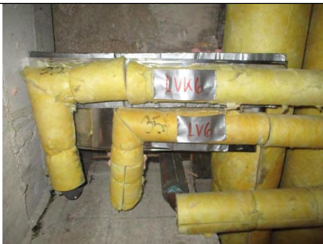
LVK6: Kellarikerros, Putkikanaali; Lv-kunkohaara l hell  kanaalin katon rajaa 12/1,0 mm.
