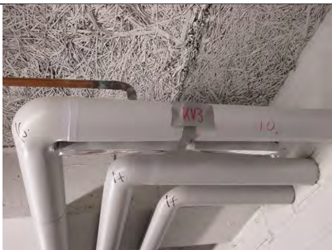
KV3: Pohjakerros, Varastotila 0.60; Kv-runkohaara tilan katon rajassa 35/1,5 mm.
