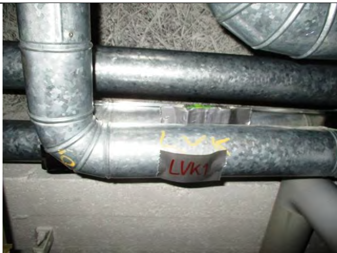
LVK1: Pohjakerros, Lämmönjakohuonetus 0.54;Lv-k-runkolinja tilan katon rajassa lähellä lv-siirrintä 35/1,5 mm.
