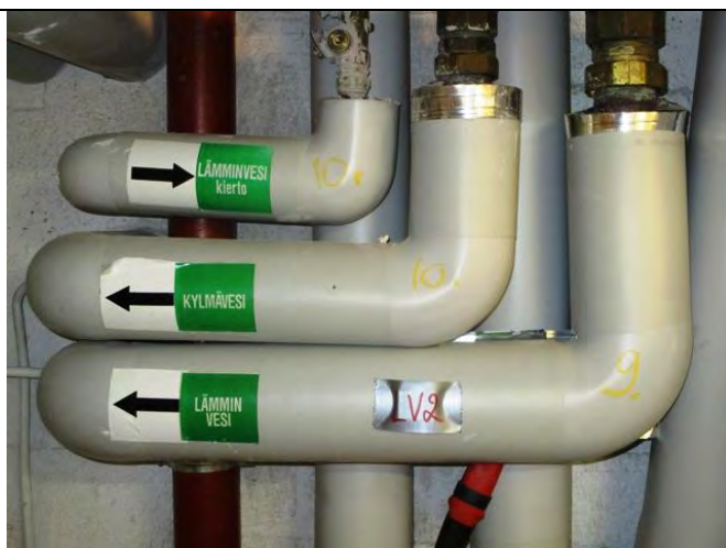
LV2: Pohjakerros, Lämmönjakohuonetila 0.54; Lv- runkohaara tilan seinustalla lähellä lv-siirrintä 54/1,5 mm.
