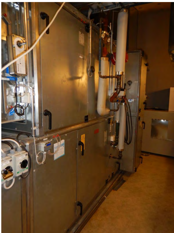
Kuva 35. Yleiskuva TK7/PK7 koneesta.
