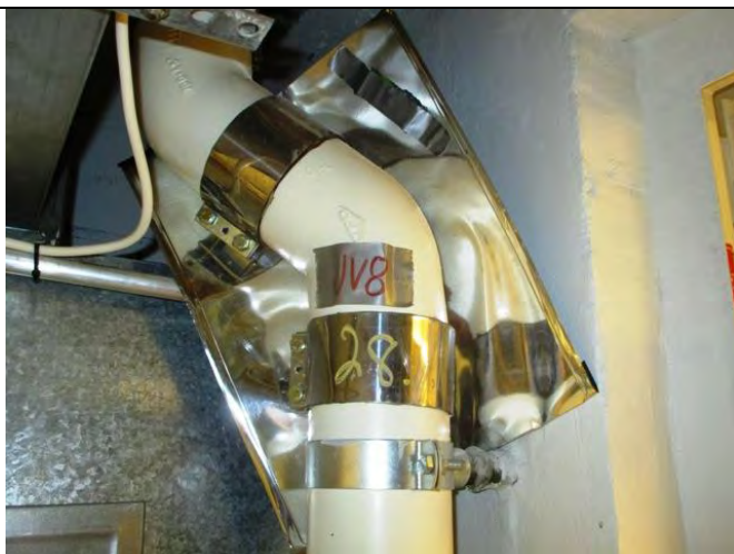
JV8: Pohjakerros, Iv-konehuonetila 0.06; Jv-viemäriin putkiosat tilan ovipielen seinustalla 110/5,0 mm.
