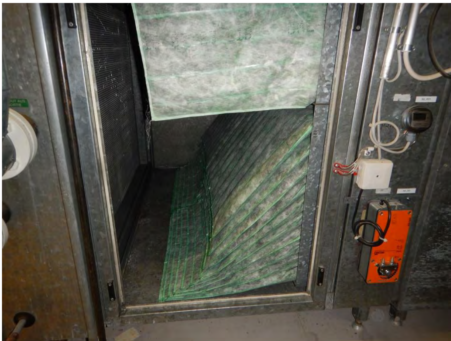
Kuva 20. Suodattimet on asennettu osittain väärään asentoon.
