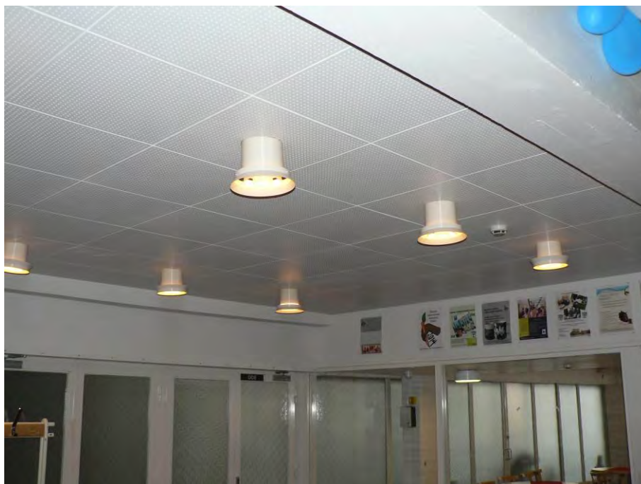
S-kuva 16. Yleiskuva aulatilasta valaisimista.
