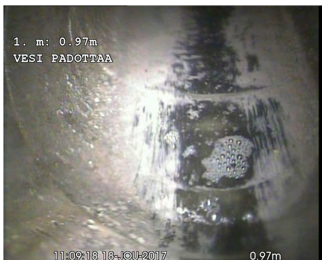
Kuva 4. Viemärissä on paikoin padotusta.
