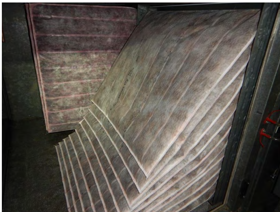
Kuva 30. Suodattimet on asennettu osittain väärin.
