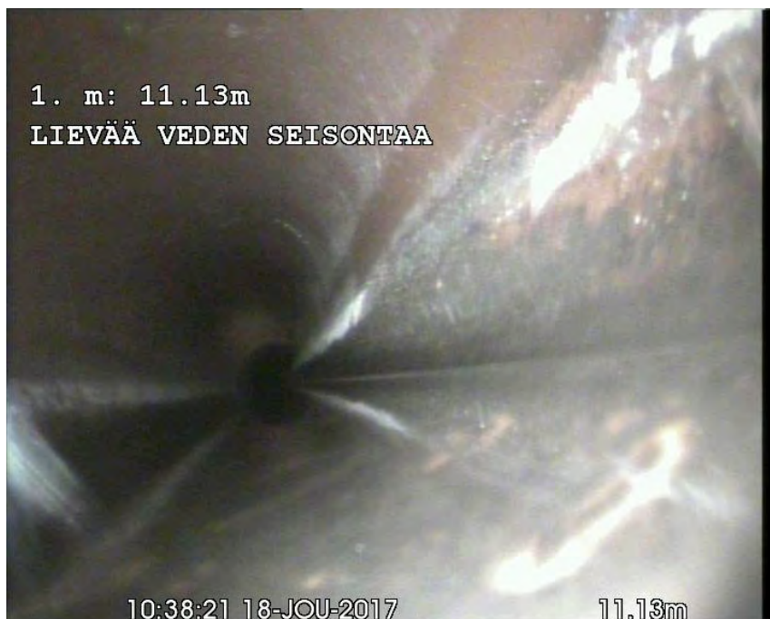
Kuva 12. Viemärin pohjalla on paikoin seisovaa vettä.
