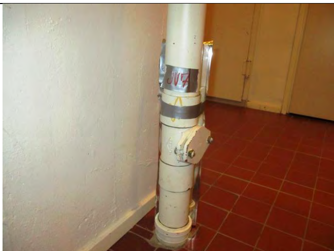
JV7: Pohjakerros, Keskushalli 0.12; Jv-viemäriinlinjan pystyputkiosat pilarin vierus- talla lähellä lattiaa rajaa 75/4,0 mm.
