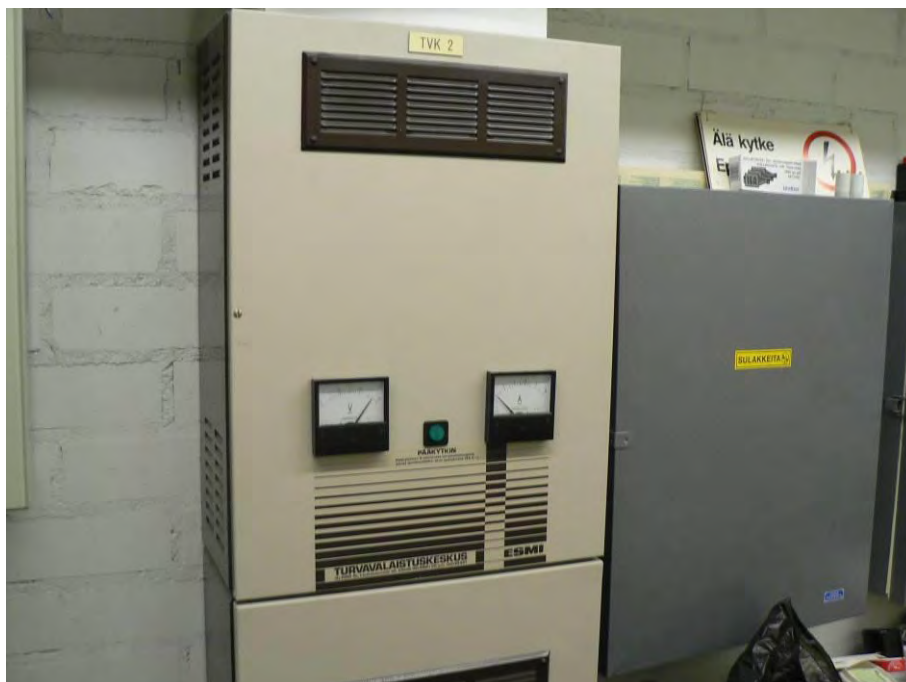
S-kuva 18. Pääkeskushuoneeseen asennettu turvavalaistuskeskus.
