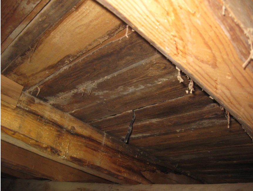
Eteisalueen vaurioitunutta laudoitusta
