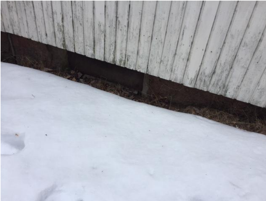
Alakoulun ryömintätilan tuuletusluukkuja suljettu "pysyvästi". Kivijalan korkeus huomattavan alhainen paikoitellen. Ajan myötä maanpinta on myös voinut nousta.
