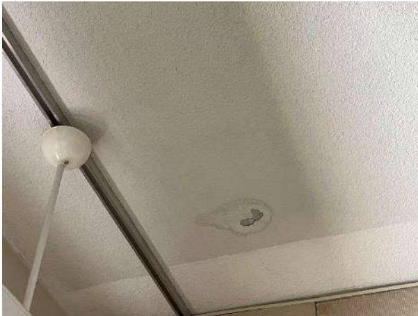
Kuva 42. Toimistohuoneissa havaittiin yksittäisiä vuotojälkiä kattopinnoilla.
