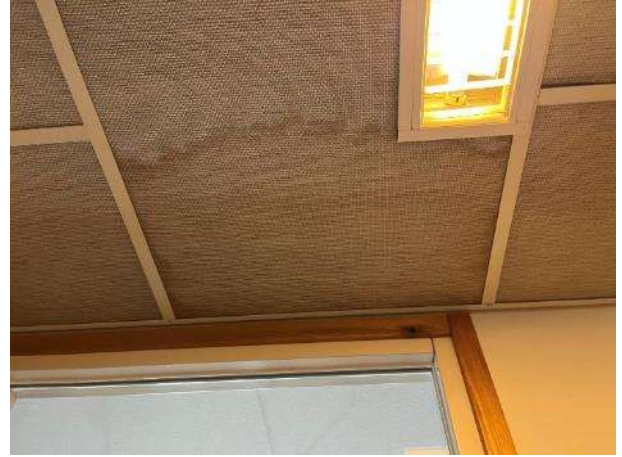
Kuva 41. Neljännen kerroksen käytävillä havaittiin joitakin vuotojälkiä kattojen alaslaskulevytyksissä.
