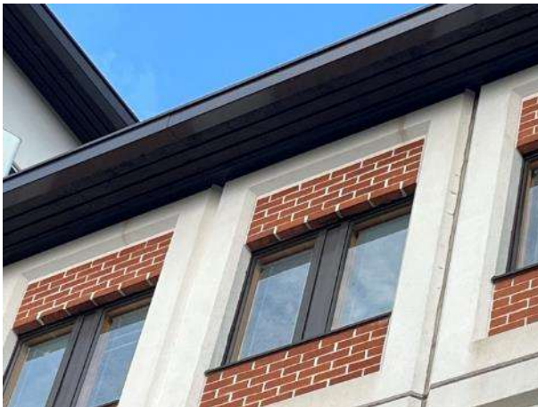
Kuva 38. C-siiven ulkoseinässä huoneiden C432 ja C 433 kohdalla havaittiin joitakin valumajälkiä.
