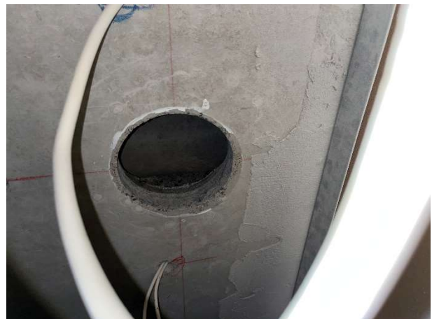
Kuva 46. Laskettujen kattojen yläpuolella reikiä ontelolaattojen ontelokanaviin 4. kerroksen C-siivessä.
