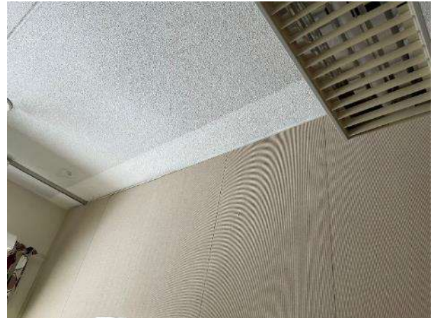
Kuva 43. Useassa toimistohuoneessa on seinäpinnoilla vanhaa akustointilevyä (Haltex), jossa havaittiin aistinvaraisesti tunkkaista hajua. Vanhat levytykset myös keräävät pölyä ja epäpuhtauksia.
