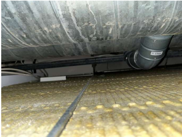
Kuva 44. Laskettujen kattojen yläpuolella avointa mineraalivillapintaa.
