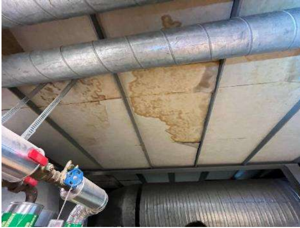
Kuva 40. Tuloilmakoneen alapuolella katon levytyksissä havaittiin kosteusjälkiä.
