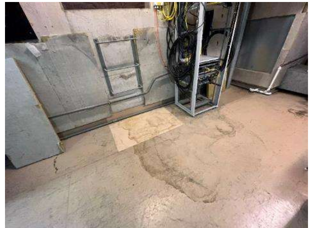
Kuva 39. Tutkittavan 4. kerroksen yläpuolella sijaitsee ilmanvaihtokonehuone. Konehuoneessa havaittiin tuloilmakoneen raitisilmakammion läheisyydessä veden lammikoitumisen jälkiä. Todennäköisesti raitisilmakammioon on päässyt lunta, joka on sulanut koneen sisältä lattialle. Tuloilmakammiossa ei havaittu olevan vedenpoistoa.
