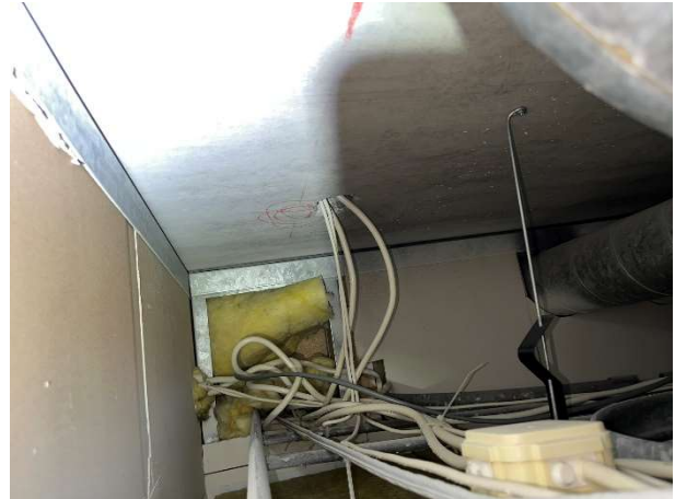
Kuva 45. Laskettujen kattojen yläpuolella avointa mineraalivillapintaa.
