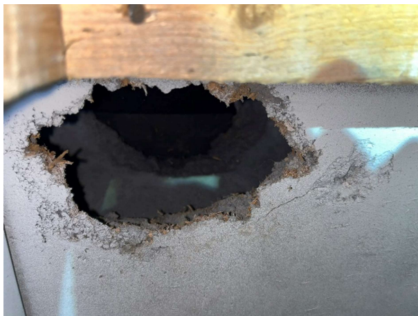
Kuva 46. Laskettujen kattojen yläpuolella reikiä vesikattorakenteiden alapuoliseen eristetilaan 4. kerroksen C-siivessä.
